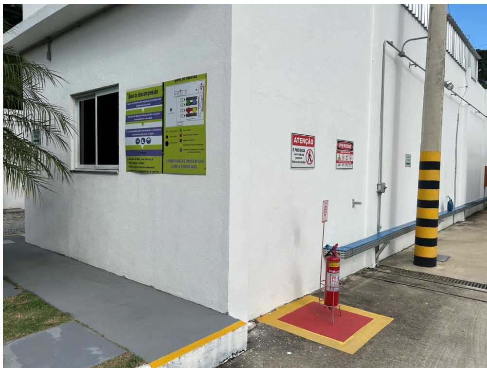
Foto 3: Orientações e sinalizações de segurança e extintor de incêndio.
