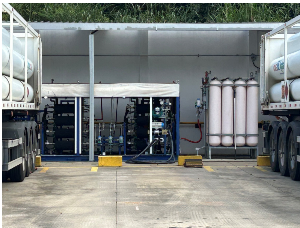
Foto 2: Unidades de Redução e Controle de Pressão (RCU).
