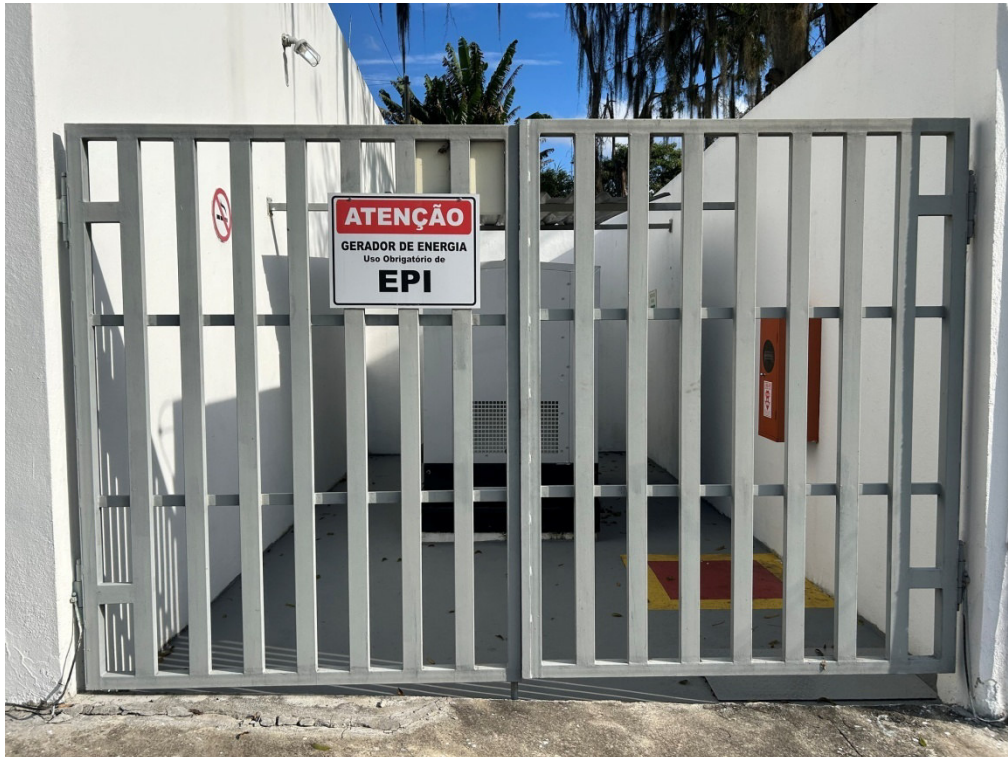
Foto 7: Gerador de energia.
