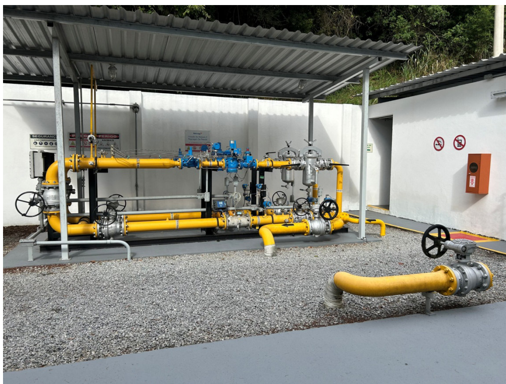
Foto 4: Estação de regulação e medição.
