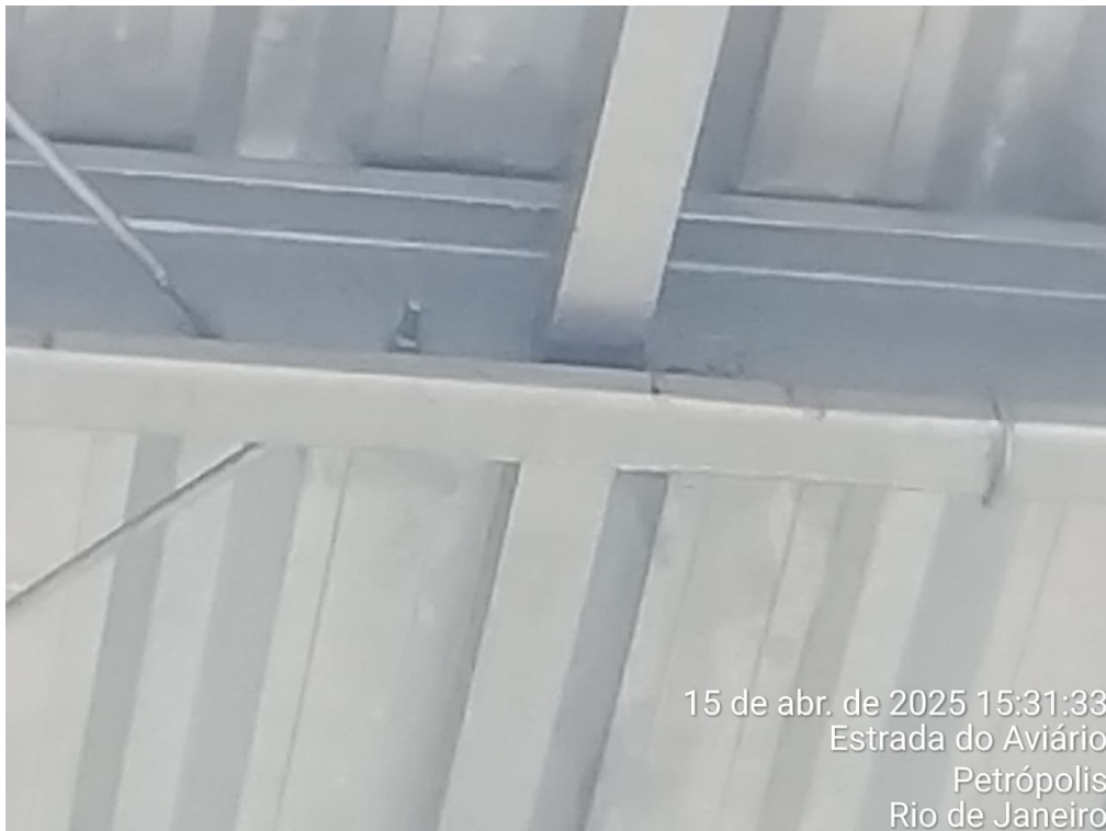
Foto 10: Ninho de pássaro retirado posteriormente da cobertura da estação.
