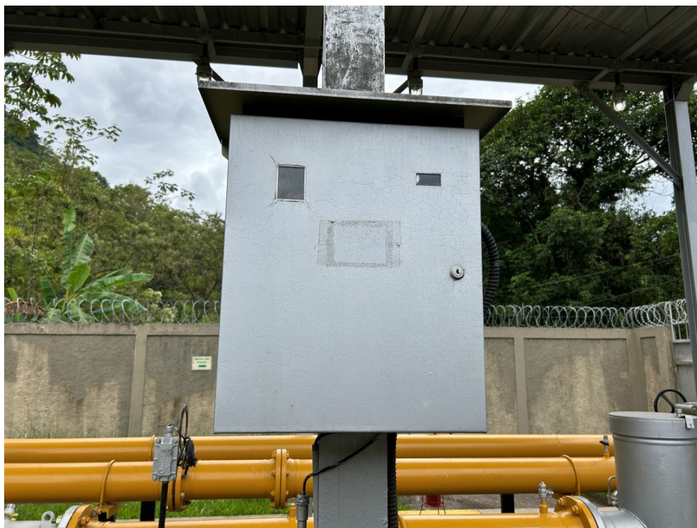
Foto 5: Painel de telemetria.
