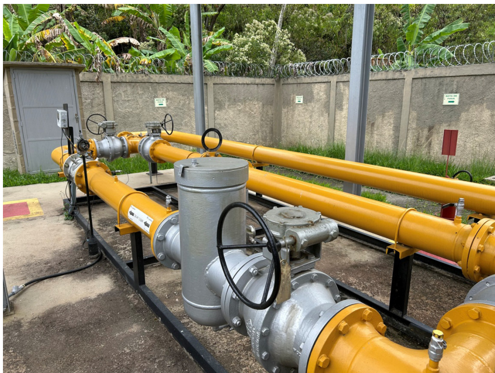
Foto 3: Tubulações da estação de medição.
