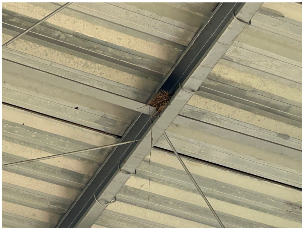
Foto 7: Ninho de pássaro visível na cobertura da estação.
