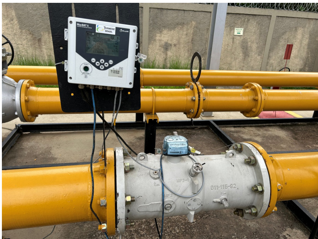
Foto 4: Medidor de vazão do tipo turbina e conversor de volume.
