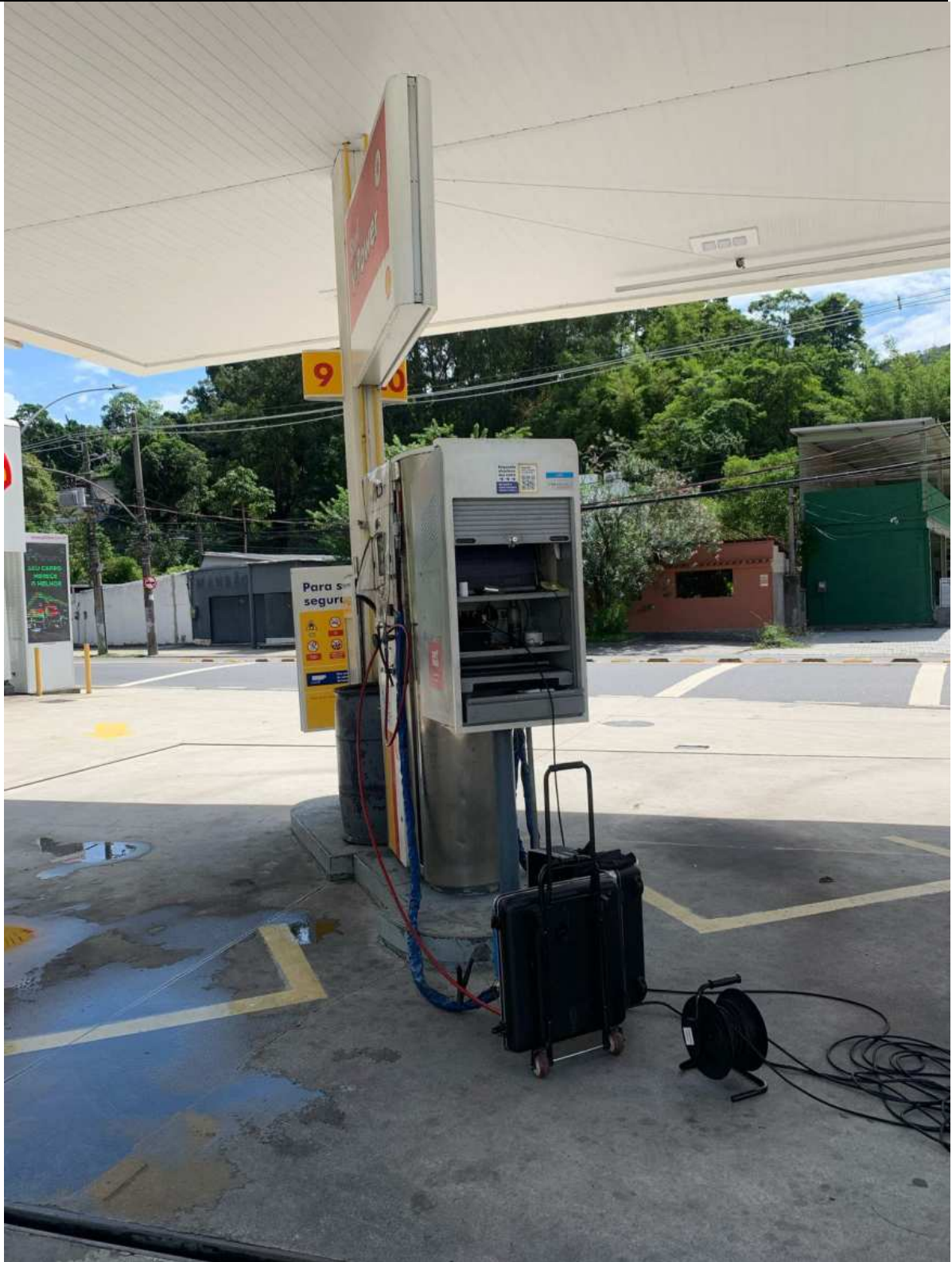
Foto 8: Equipamentos do IPEN, medindo o gás do posto.
