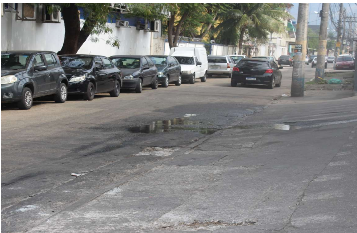
Foto 5 : recomposição com afundamentos e desnível
