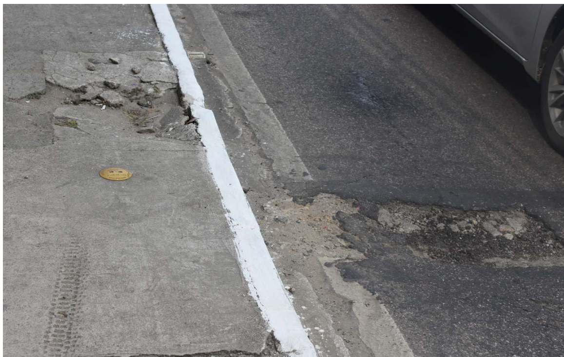
Foto 3 : afundamento da calçada e do asfalto
