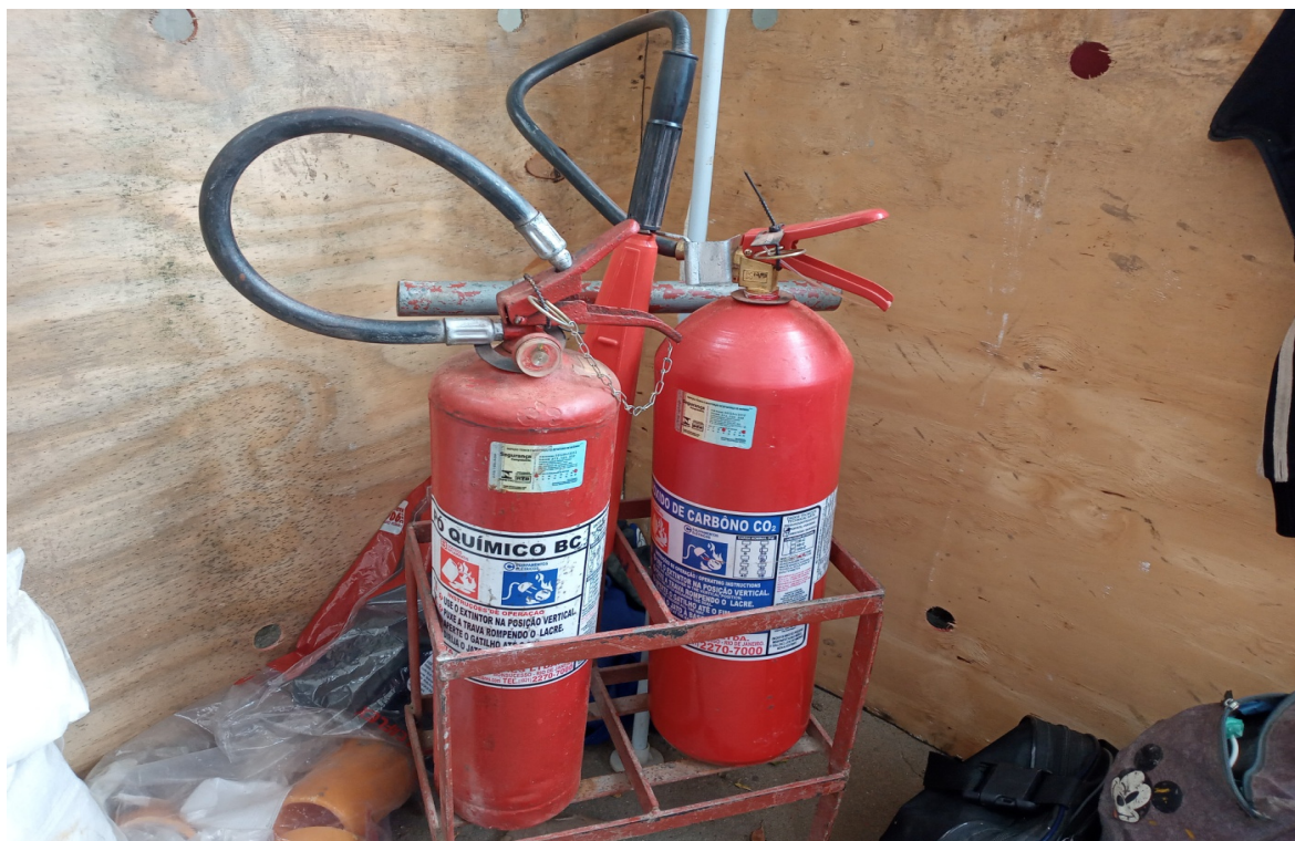
Foto 10: Extintor de PQS e CO2
