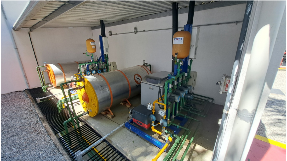
Foto 5: Sistema de Aquecimento de Água
