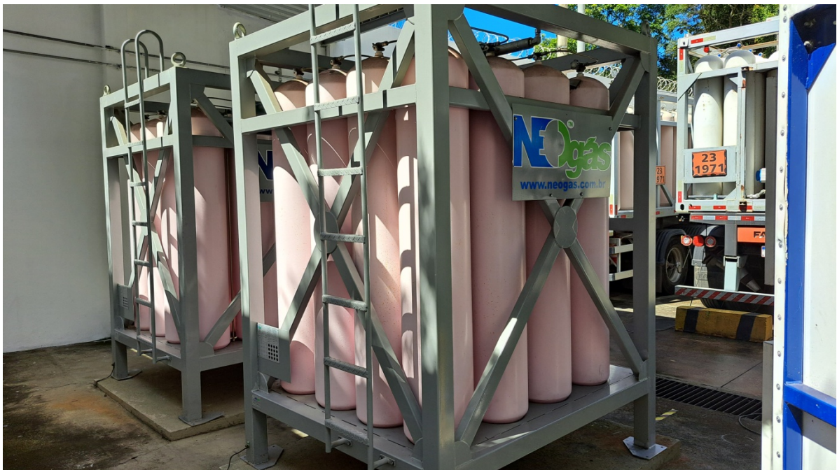
Foto 4: Cestas estacionárias de backup
