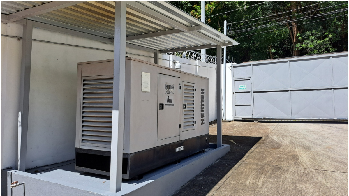
Foto 13: Gerador de Energia em caso de falta de energia.
