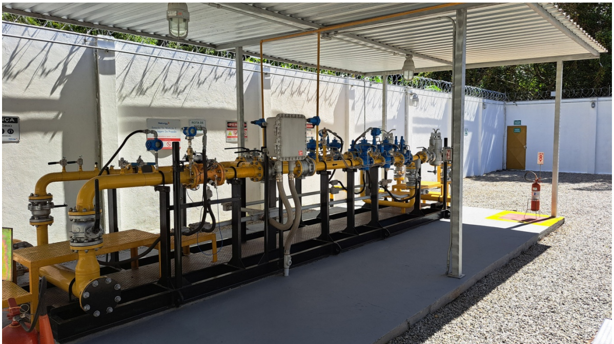
Foto 6: Skid de Regulação e Medição
