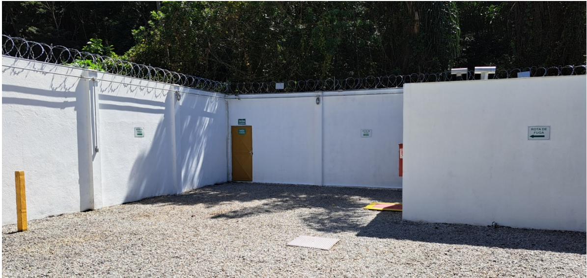
Foto 11: Sinalização de rotas de fugas e passagem extra de evacuação
