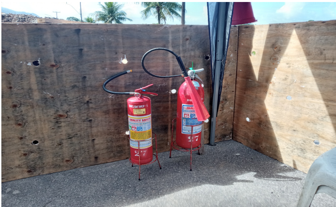
Foto 9: Extintor de PQS e CO2
