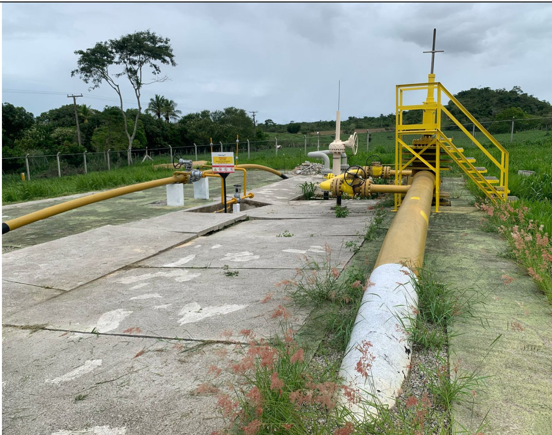
Foto 3: Gasoduto de aço e válvula de bloqueio.
