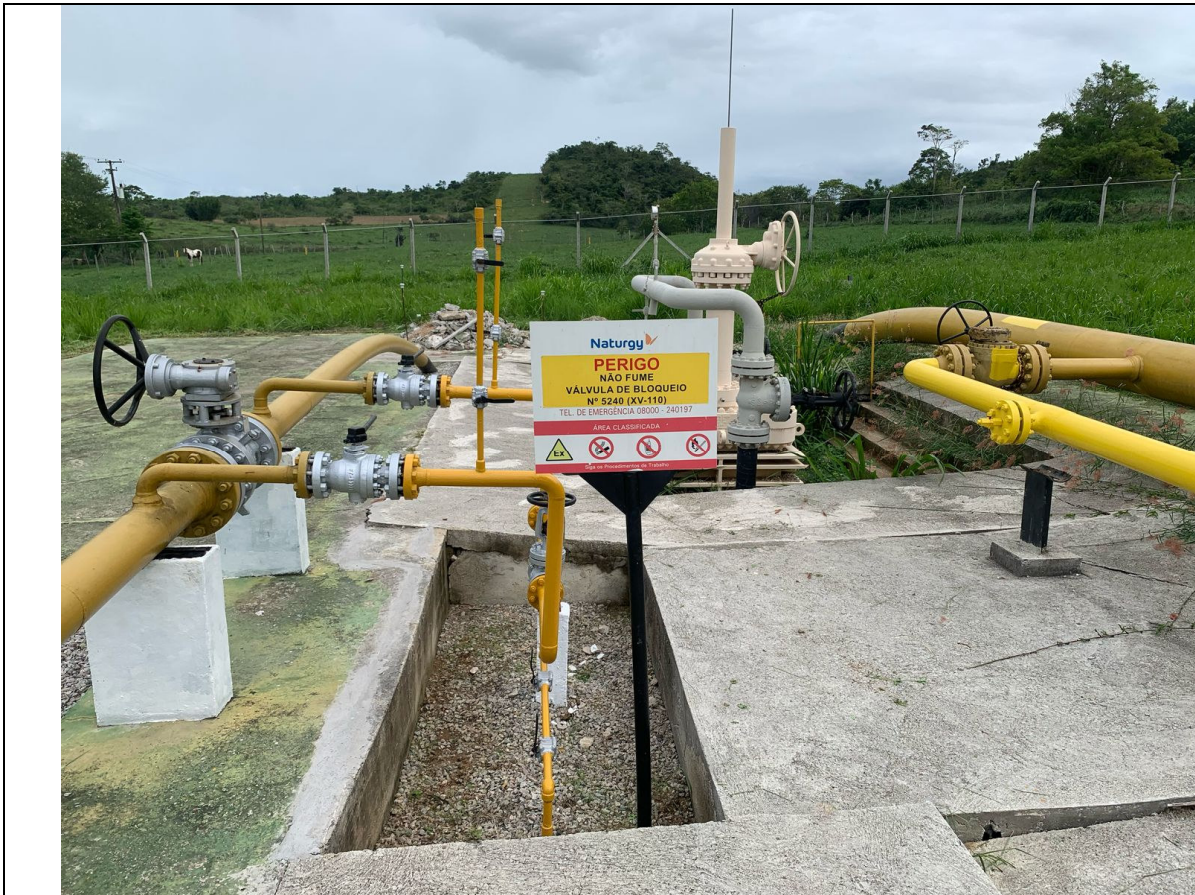
Foto 4: Placa de aviso da estação da válvula de bloqueio.
