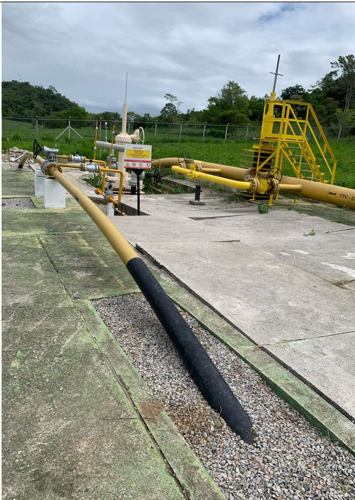
Foto 6: Gasoduto de aço e válvula de bloqueio.
