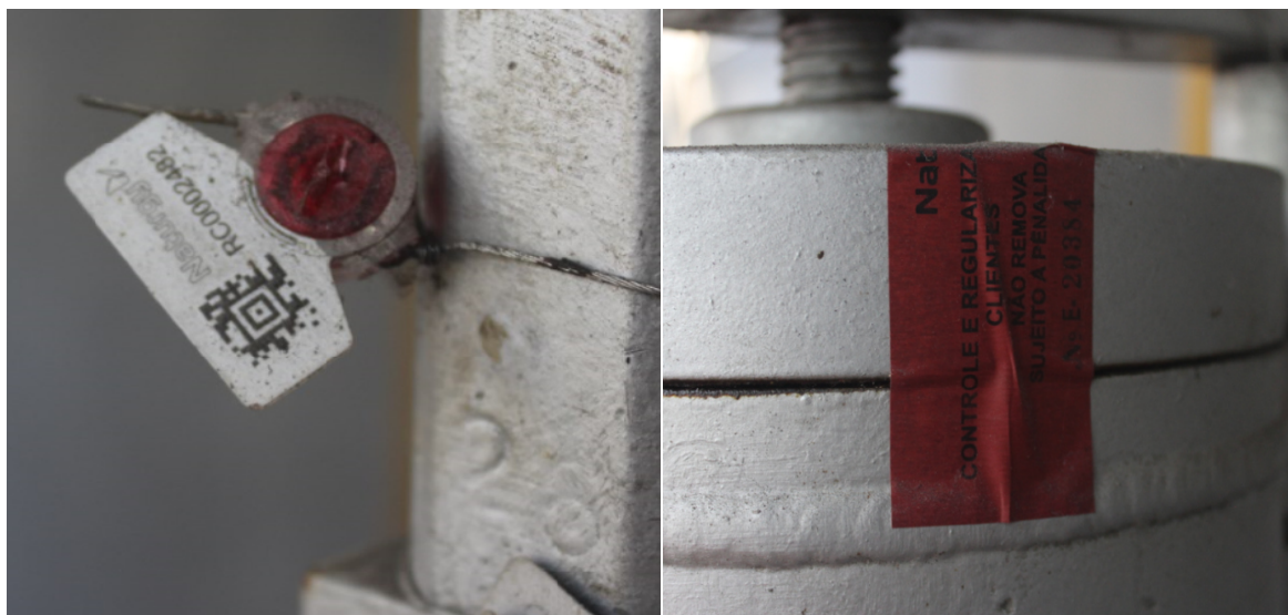
Figura 8 - Alguns dos lacres da tubulação e do filtro
