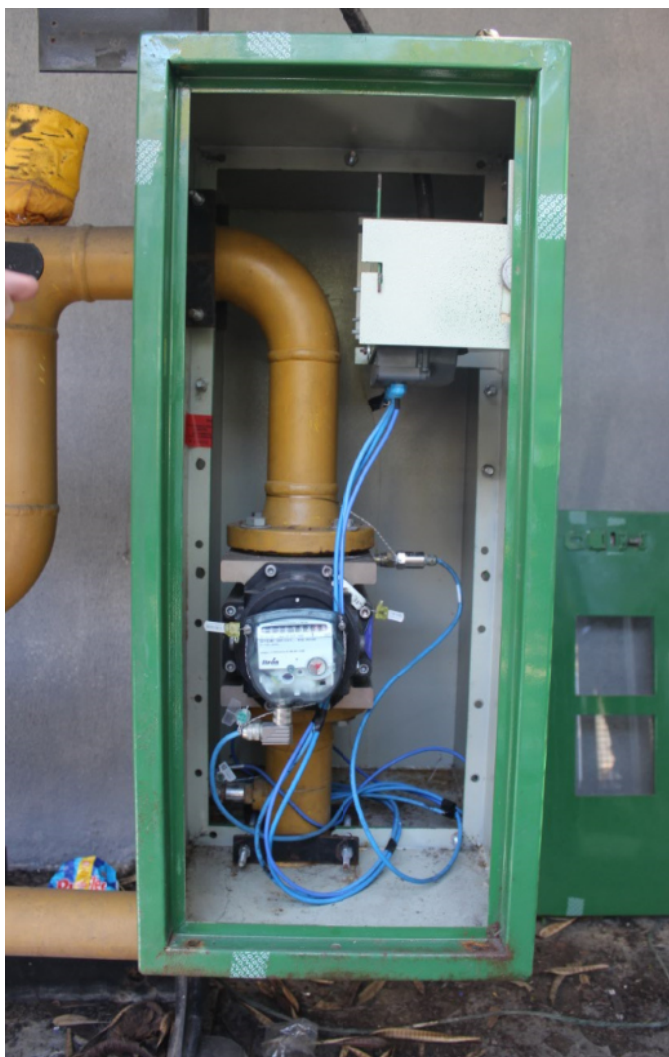
Figura 10 - Caixa do medidor aberta
