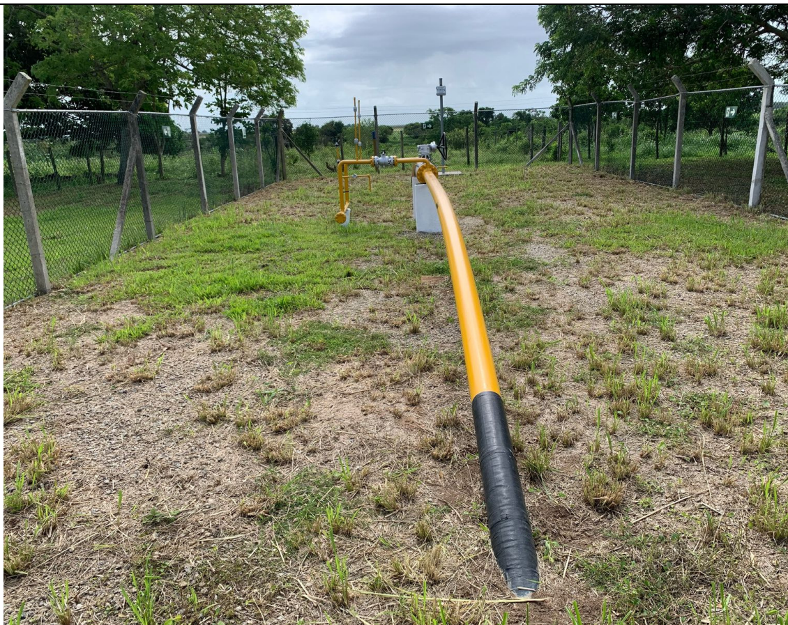
Foto 6: Válvula de bloqueio.
