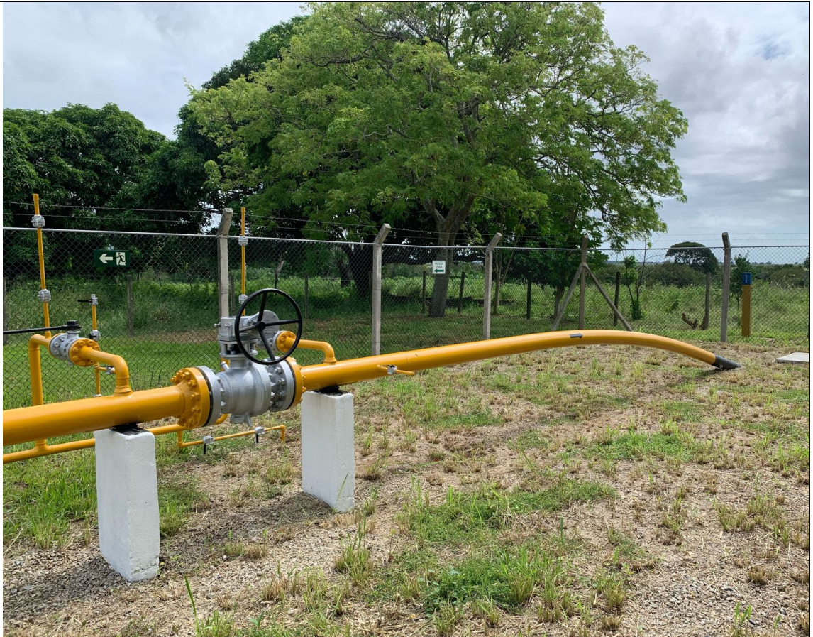
Foto 3: Gasoduto de aço e válvula de bloqueio
