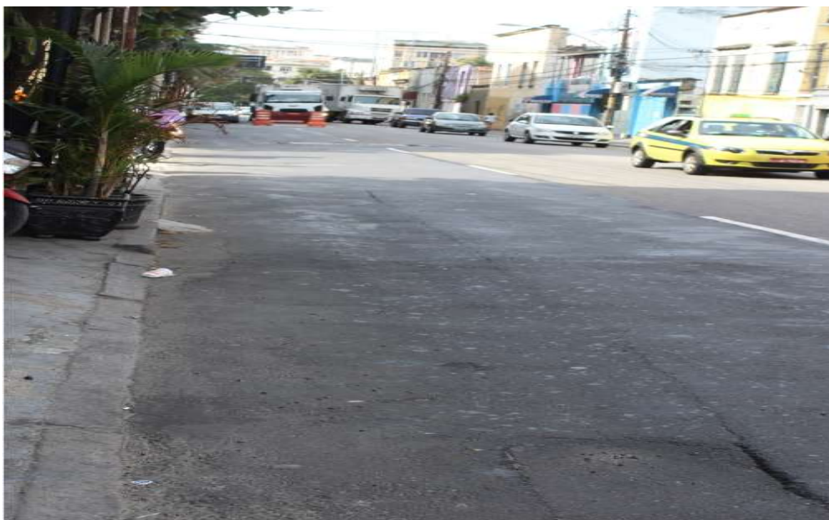
Foto 3 : recomposição com afundamento
