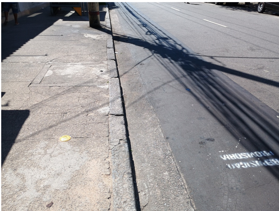
Foto 7: trecho de recomposição provisória identificado.
