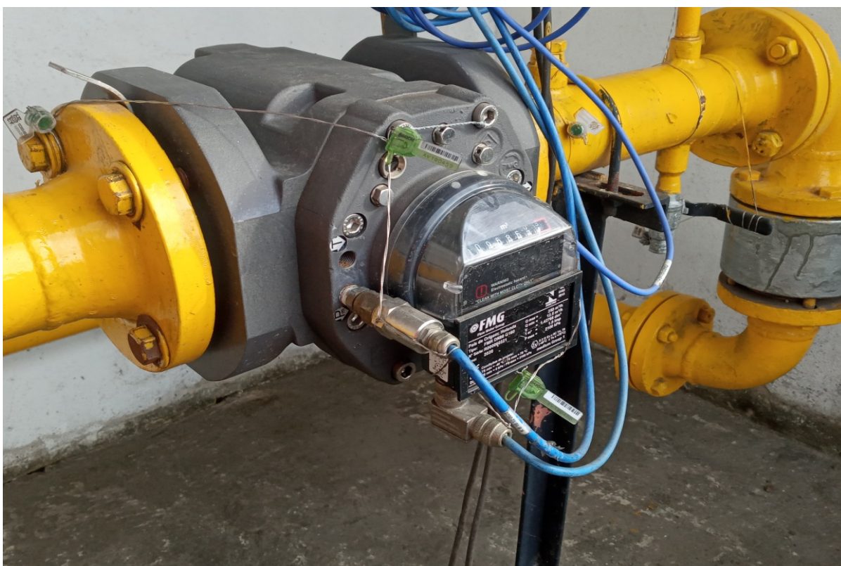
FOTO 8: Medidor de vazão de GNV (com lacre).
