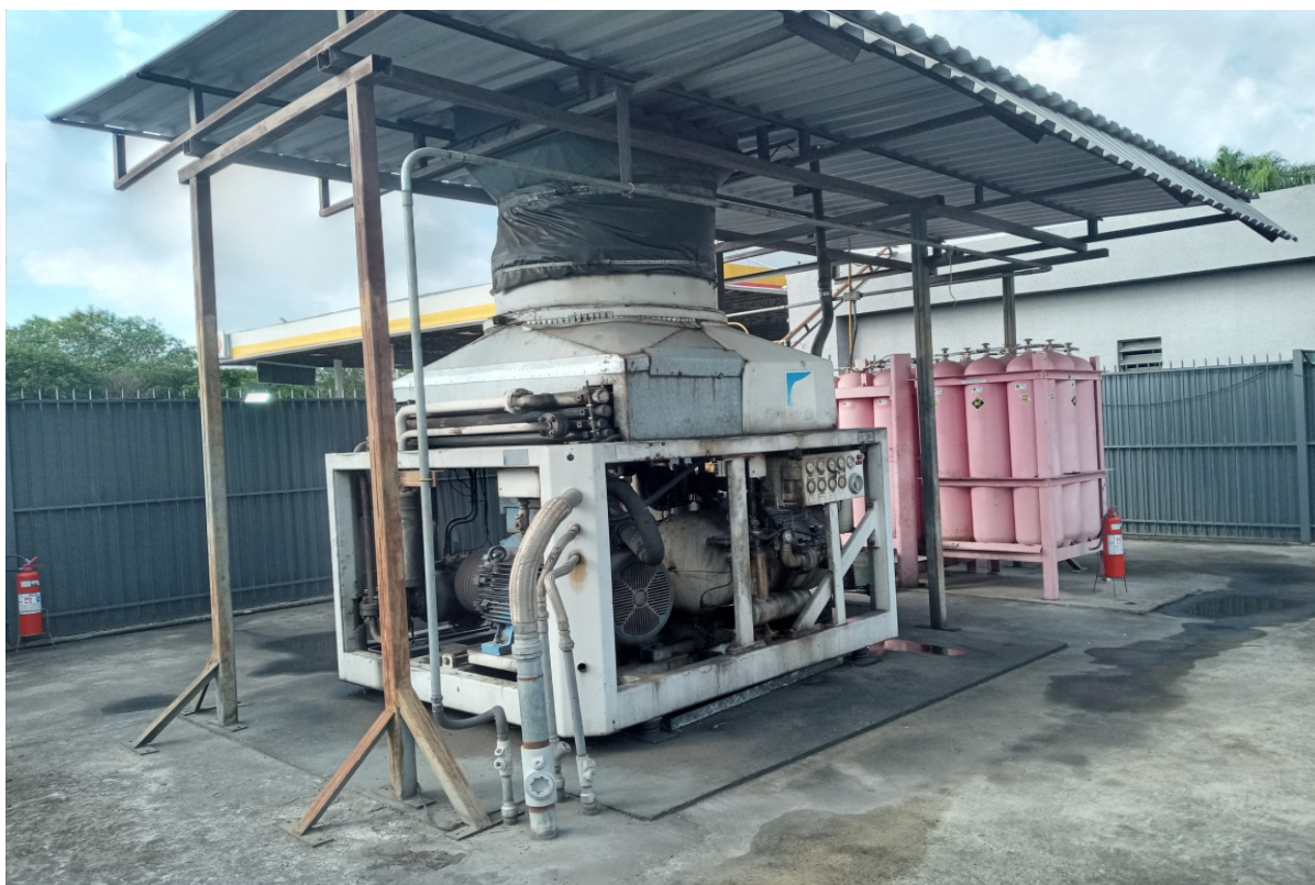
FOTO 15: Compressor de GNV
