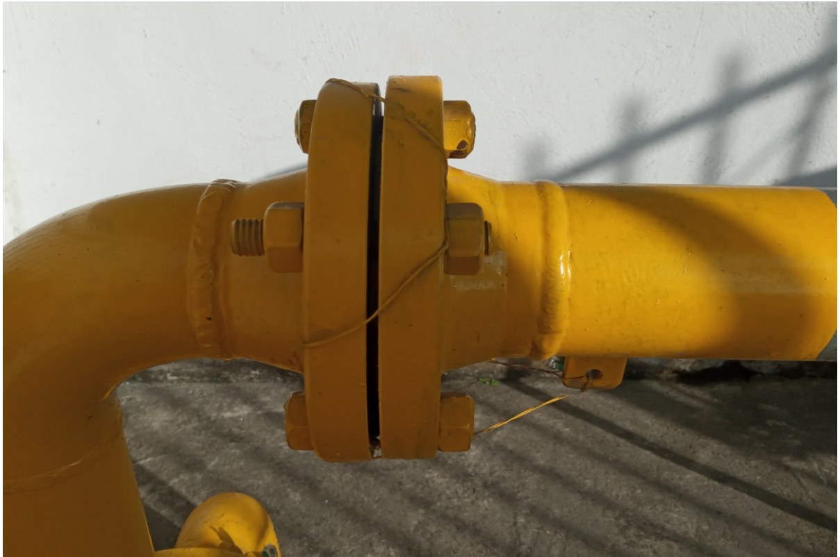
FOTO 3: Conexão entre flanges (com lacre).
