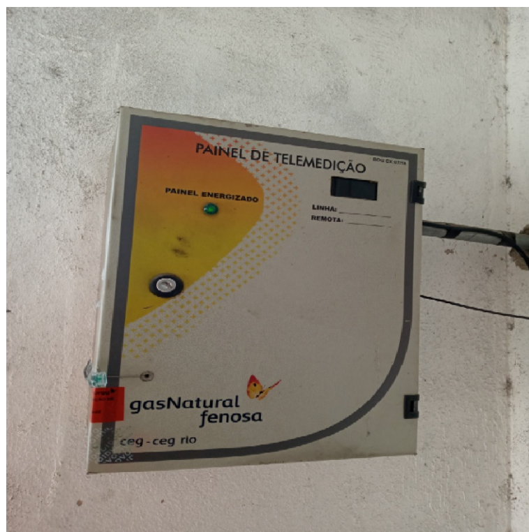
FOTO 13: Painei de telemedicação (com lacre)
