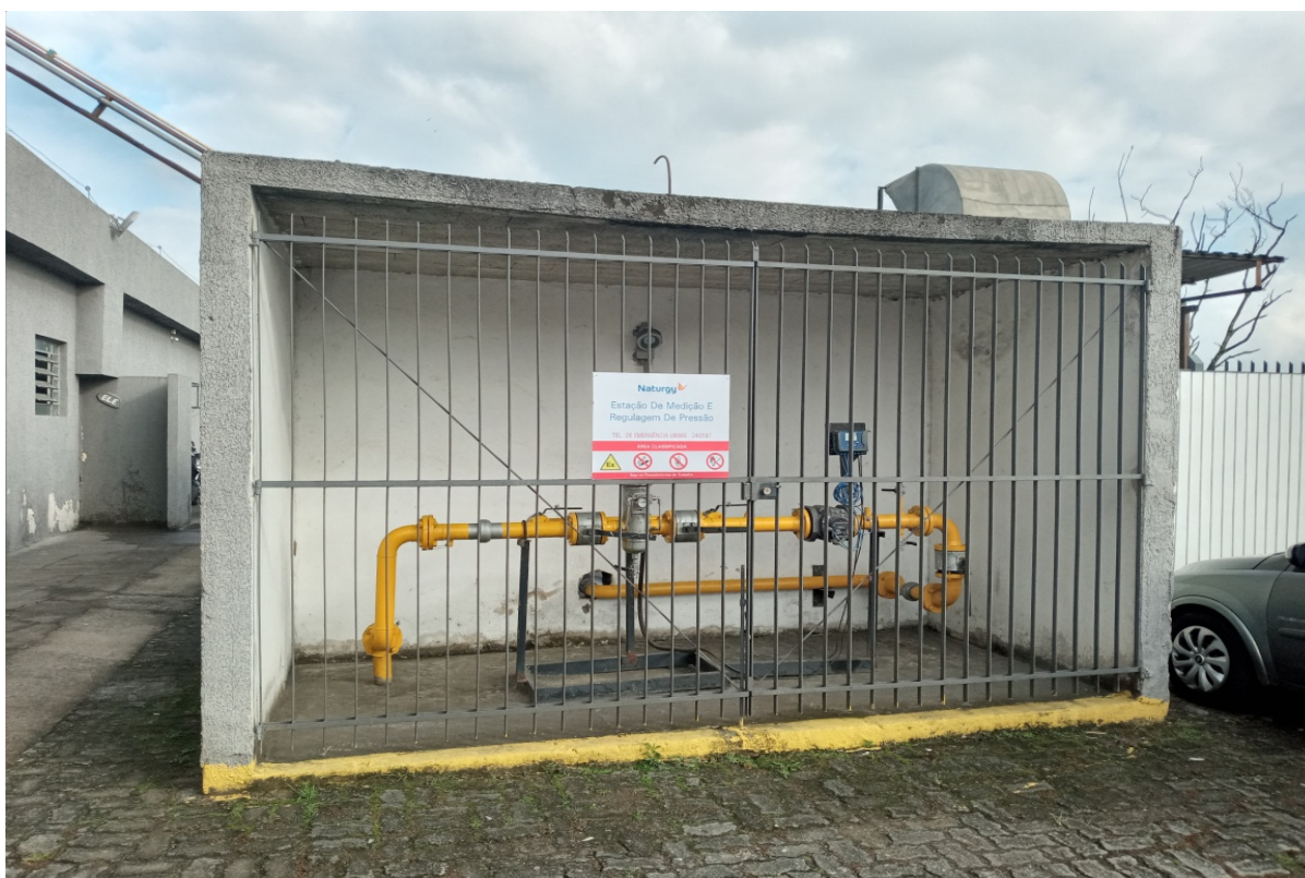
FOTO 2: Estação de Medição e Regulagem de Pressão.
