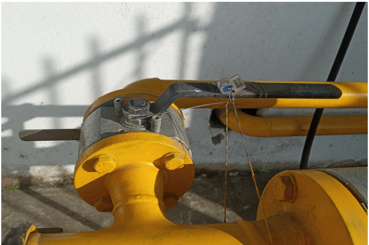
FOTO 4: Válvula de bloqueio a montante do by-pass fechada e com lacre.
