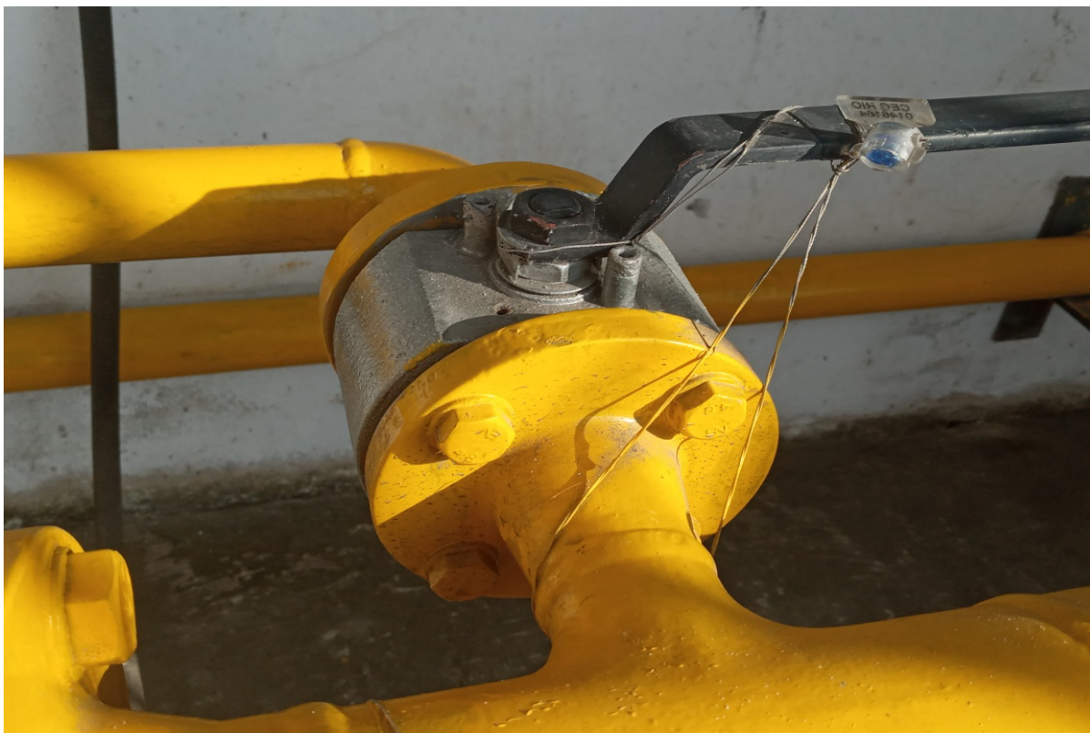
FOTO 7: Válvula de bloqueio a jusante do by-pass fechada e com lacre.
