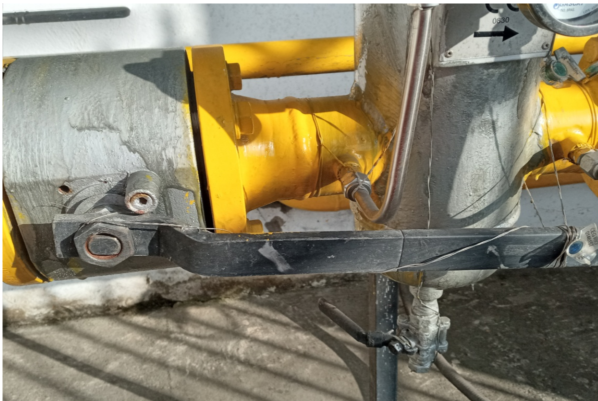
FOTO 5: Válvula de bloqueio aberta (com lacre).
