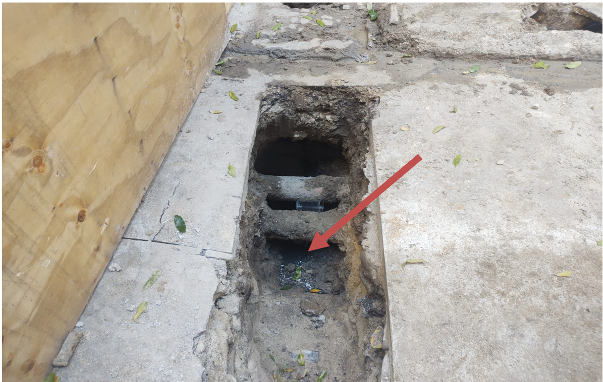
Foto 6: Valas para instalação de ramais em frente aos números 53 e 47 e vazamento de esgoto.
