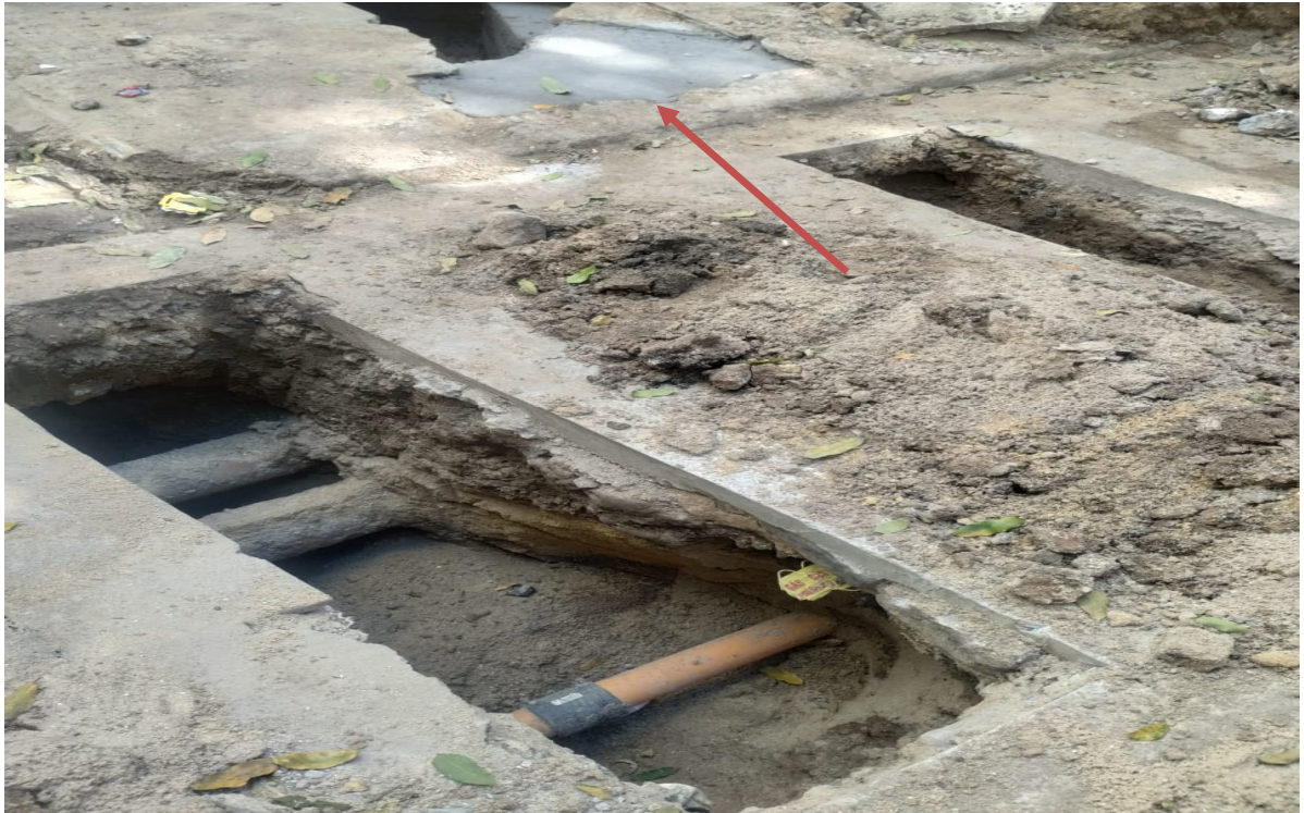
Foto 7: Vazamento de esgoto solucionado.
