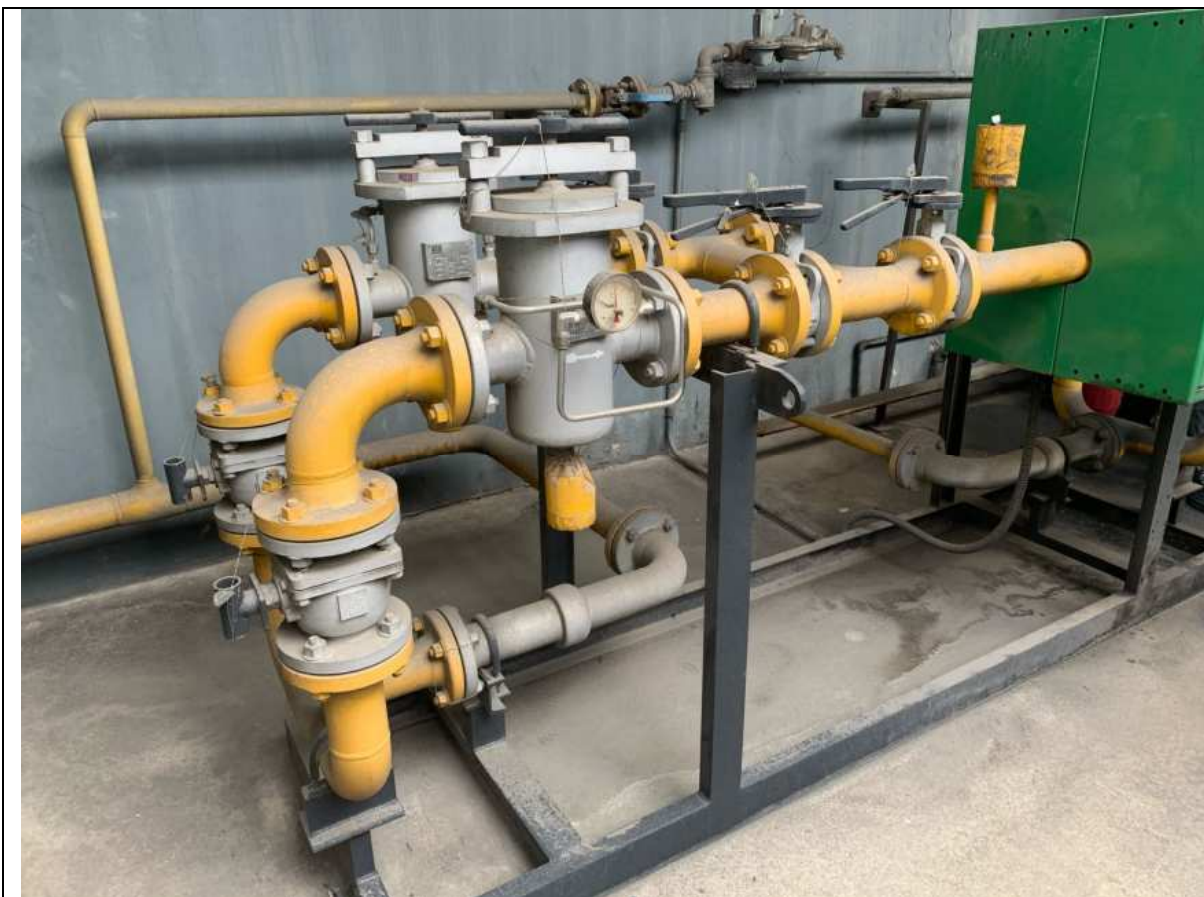
Foto 4: Estação de GNV do posto - Módulo de Medição
