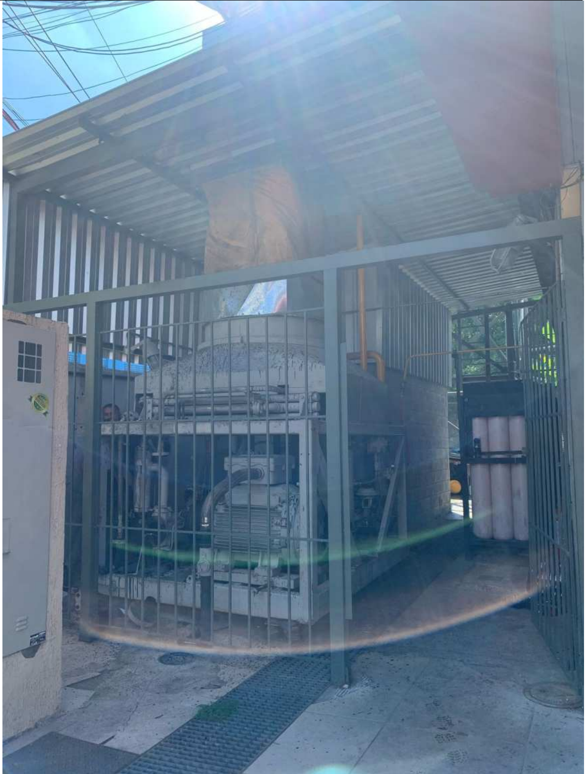
Foto 7: Compressor do posto parado em razão de problemas técnicos.
