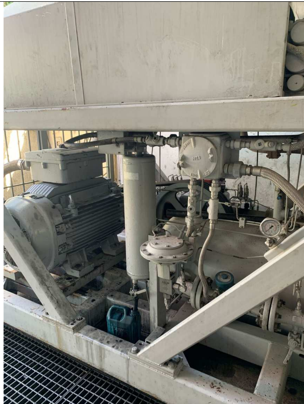
Foto 8: Compressor do posto parado em razão de problemas técnicos.
