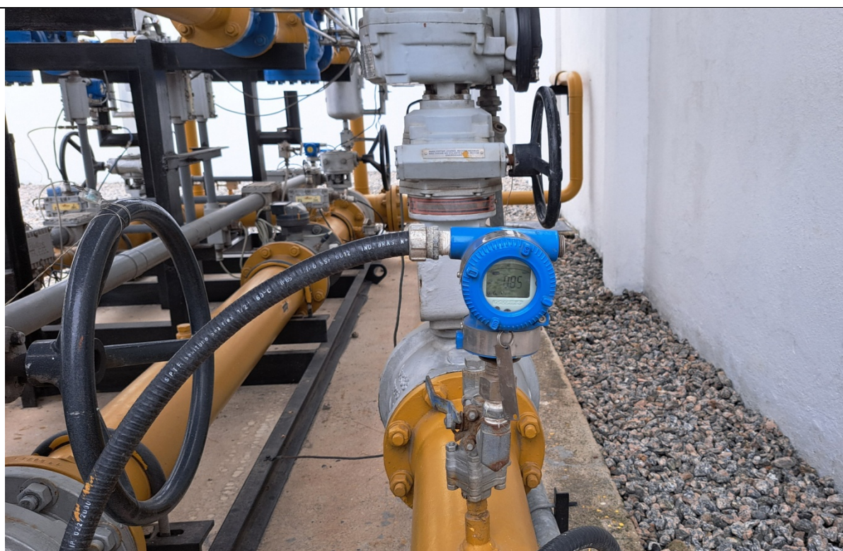
Foto 10: Detalhe de válvula de bloqueio telecomandada na linha de saída para distribuição
