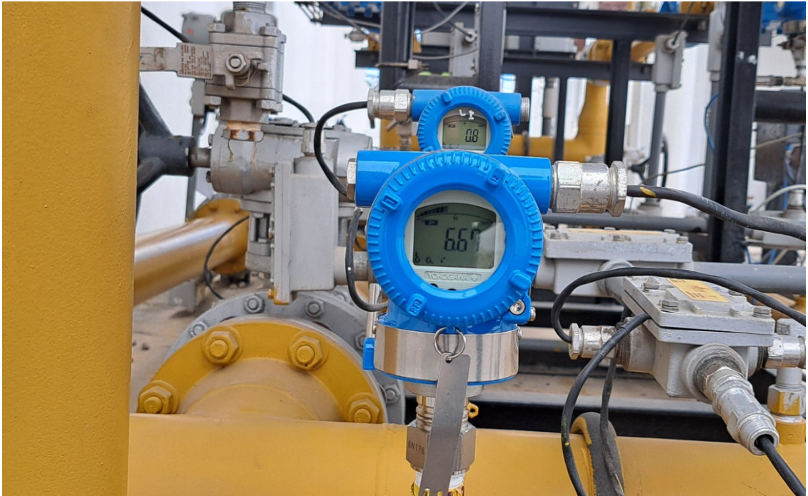
Foto 5: Pressão de entrada no módulo de regulação e medição
