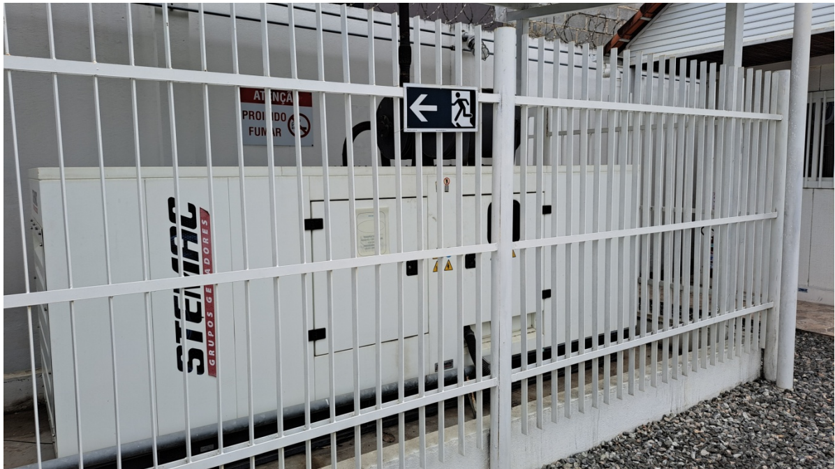
Foto 13: Gerador para suprir energia em caso de falha na rede elétrica.
