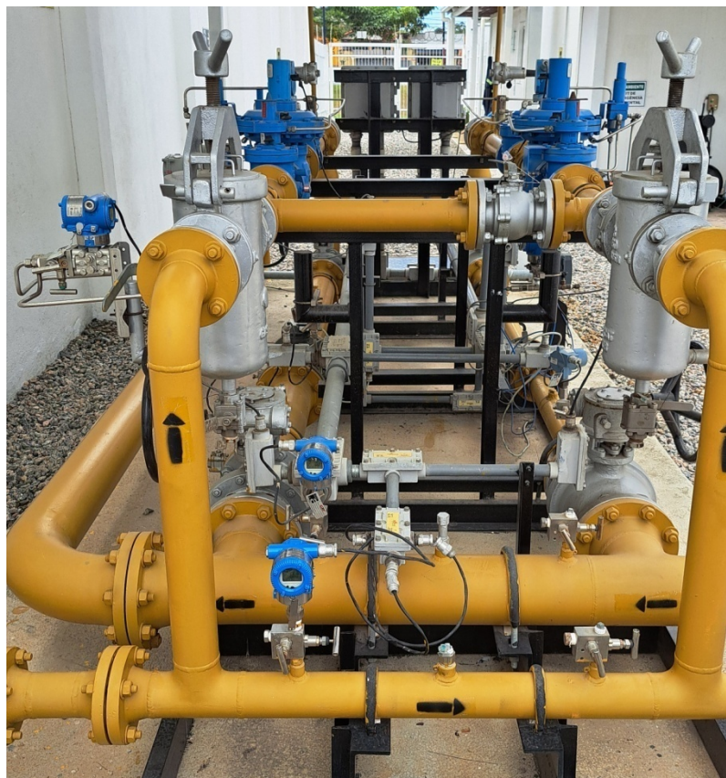
Foto 4: Skid de Regulagem e Medição
