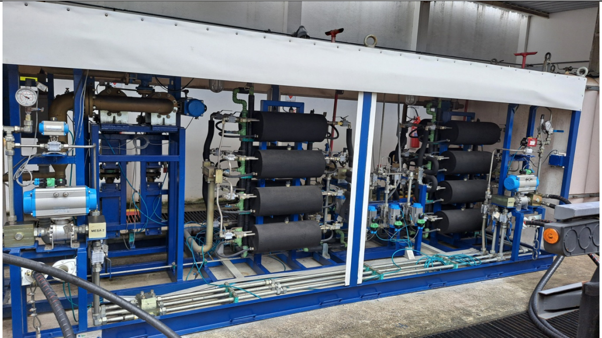
Foto 3: RCU -Unidade de Redução e Controle
