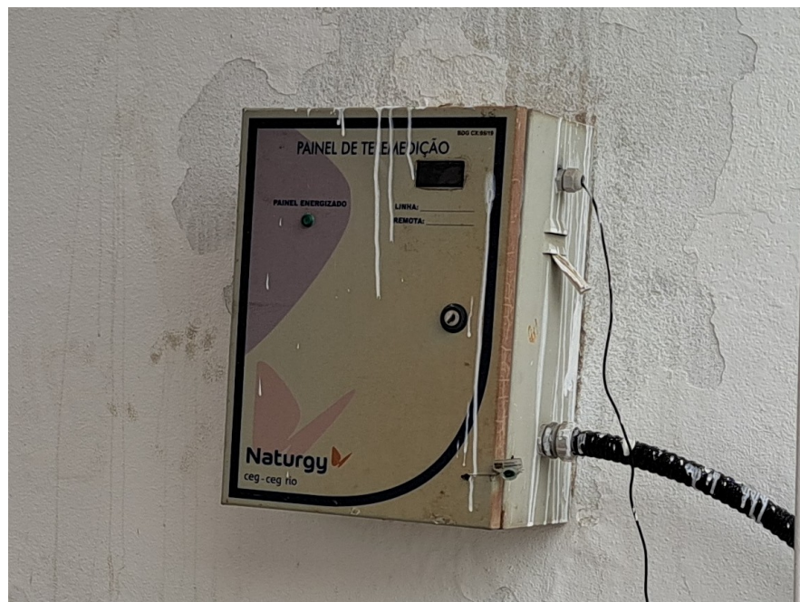
Foto 14: Sistema de telemetria Naturgy – (necessita limpeza)
