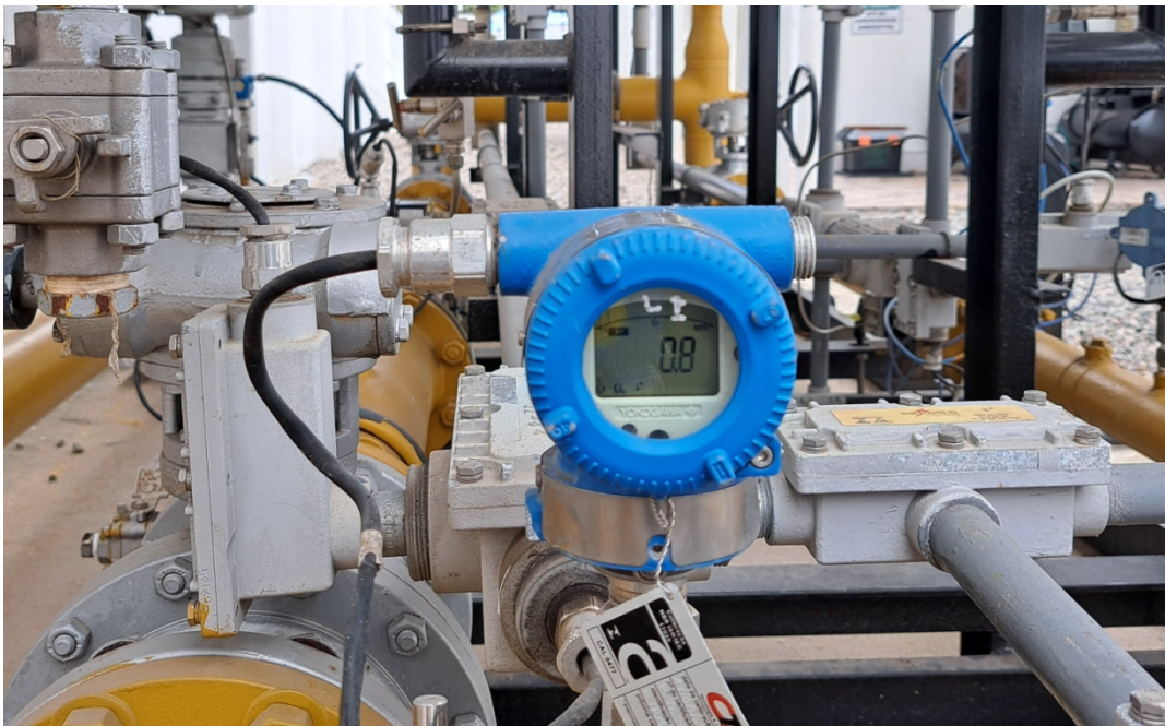
Foto 6: Pressão de saída do skid de regulação e medição
