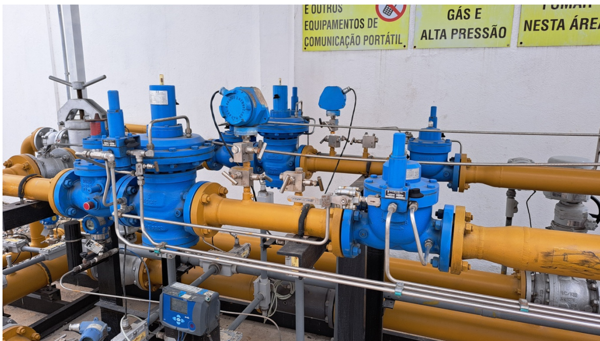
Foto 7: Válvulas Reguladoras de Pressão telecomandadas
