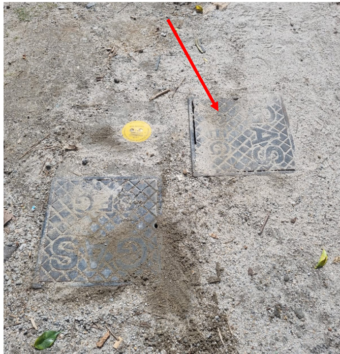
Foto 2: Válvula de segurança instalada no final da rede, na área de interligação da rede da Estrada do Moinho com a rede interna do condomínio.
