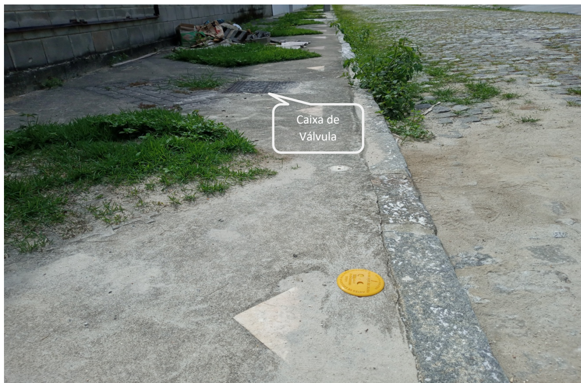
Foto 2: Válvula de bloqueio (Ponto de interligação de rede)
