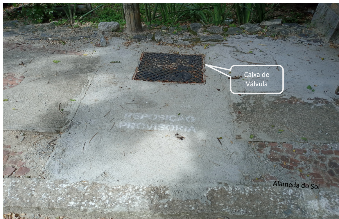
Foto 8: Válvula de bloqueio e recomposição provisória
