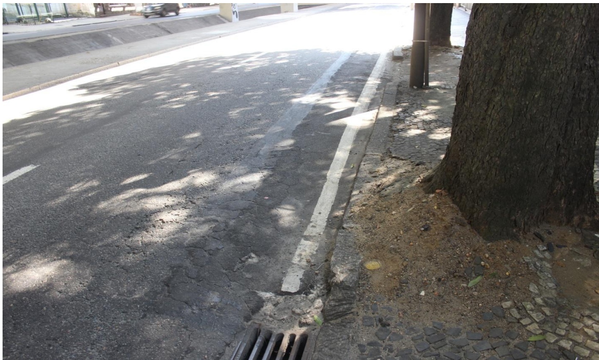
Foto 5: Recomposição da pista de rolamento apresentando trincas e buracos.
