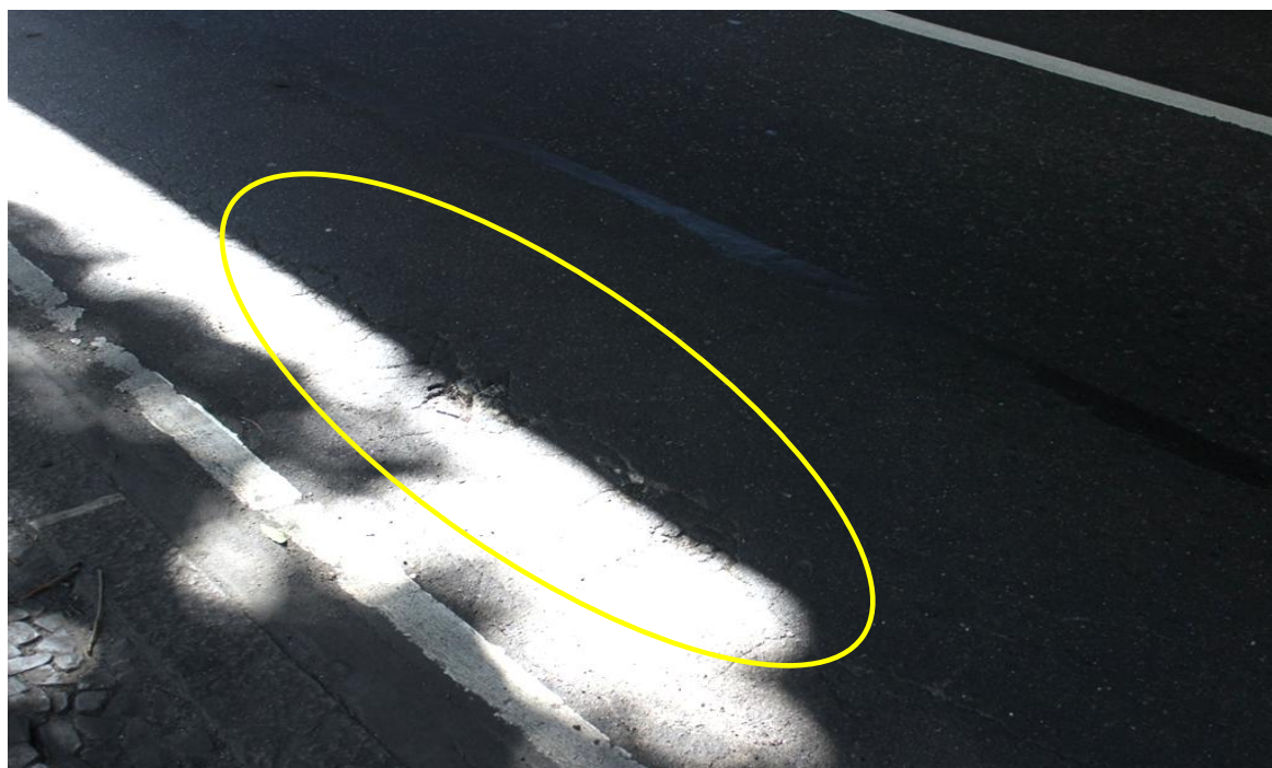
Foto 7: Recomposição na Av. Paulo de Frontin da pista de rolamento apresentando afundamento, trincas e buracos.
