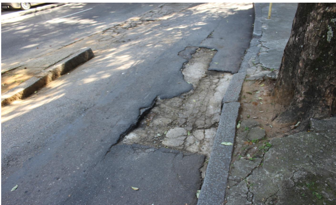
Foto 11: Recomposição na Rua Santa Alexandrina da pista de rolamento apresentando afundamento e buracos.
