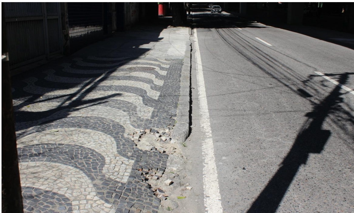
Foto 5: Recomposição da calçada apresentando descolamento das pedras portuguesas (Av. Paulo de Frontin em frente ao N° 693).
