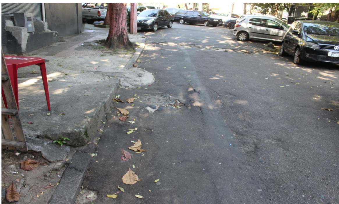
Foto 2: Recomposição na Rua Santa Alexandrina da pista de rolamento apresentando afundamento e buracos.
