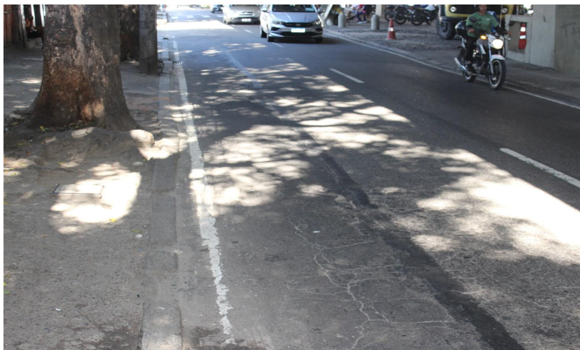
Foto 9: Recomposição na Av. Paulo de Frontin da pista de rolamento apresentando trincas.
