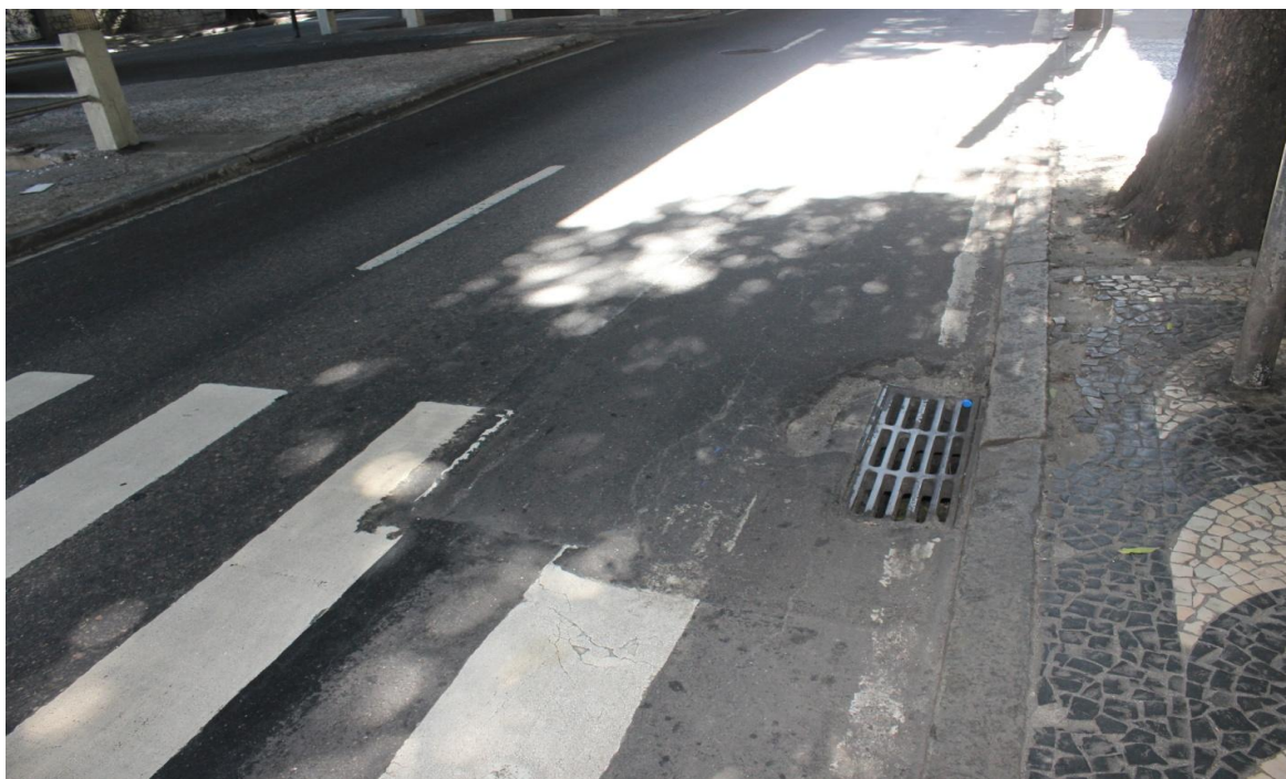
Foto 8: Recomposição na Av. Paulo de Frontin da pista de rolamento apresentando afundamento, trincas e buracos.
