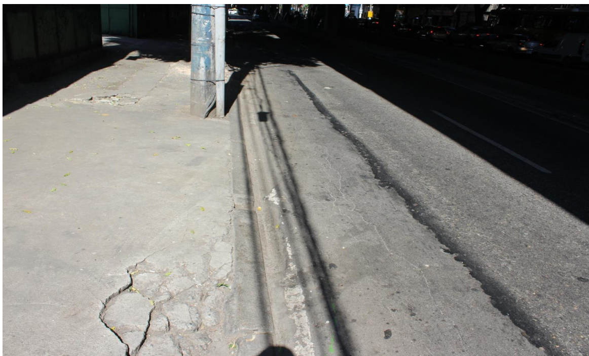
Foto 10: Recomposição na Av. Paulo de Frontin da pista de rolamento apresentando trincas.
