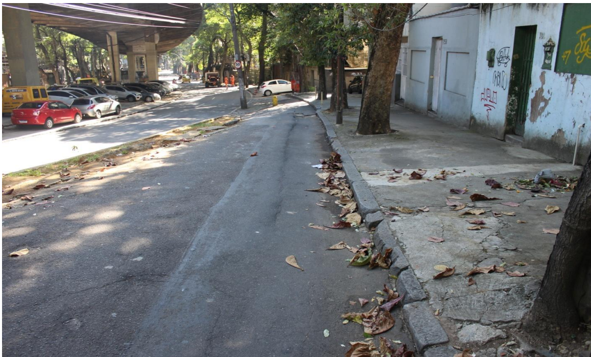
Foto 3: Recomposição na Rua Santa Alexandrina da pista de rolamento apresentando afundamento
