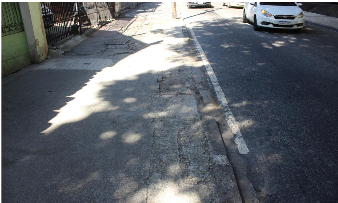
Foto 6: Recomposição da calçada apresentando buracos e afundamento. (Av. Paulo de Frontin em frente ao N° 685).
