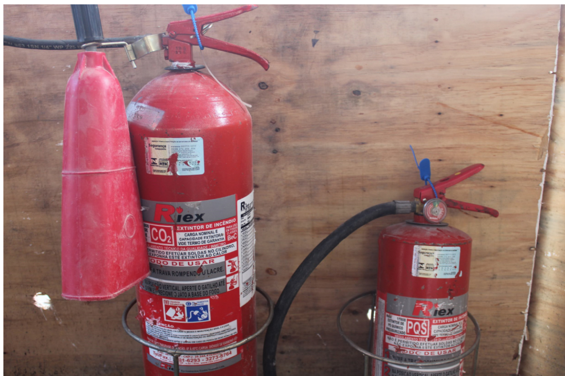
Foto 5: Extintores de incêndio
