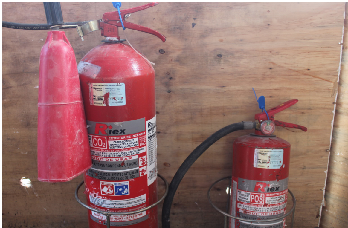
Foto 5: Extintores de incêndio
