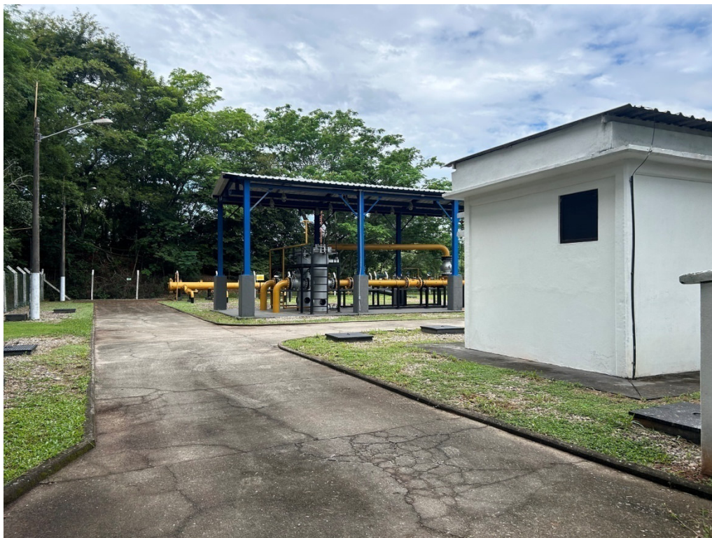
Foto 3: Vista da estação de medição (à frente) e canhão receptor de PIG (ao fundo).
