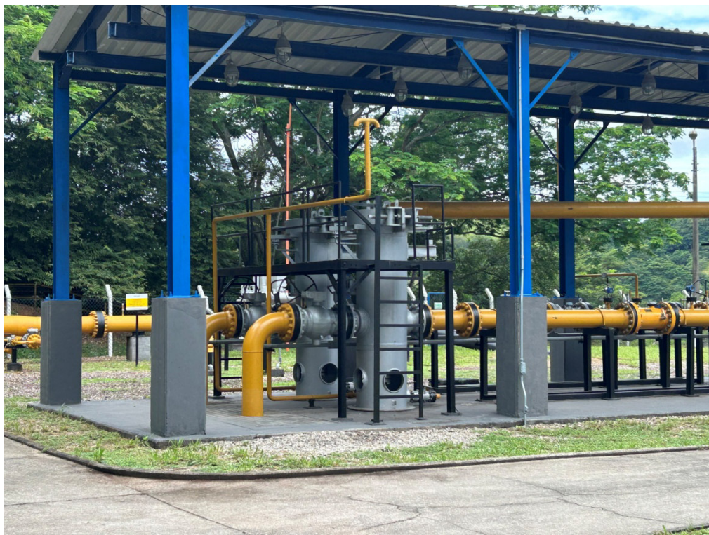
Foto 4: Estação de medição, com filtros visíveis.
