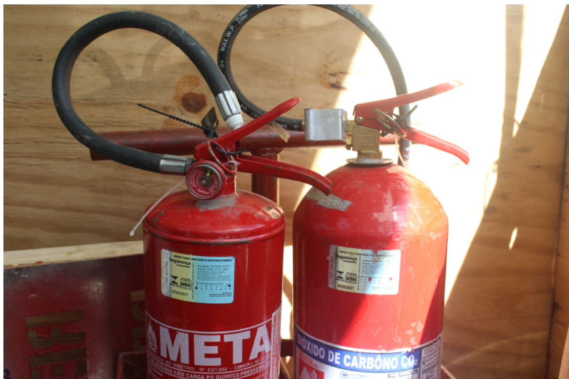
Foto 3: Extintores de incêndio
