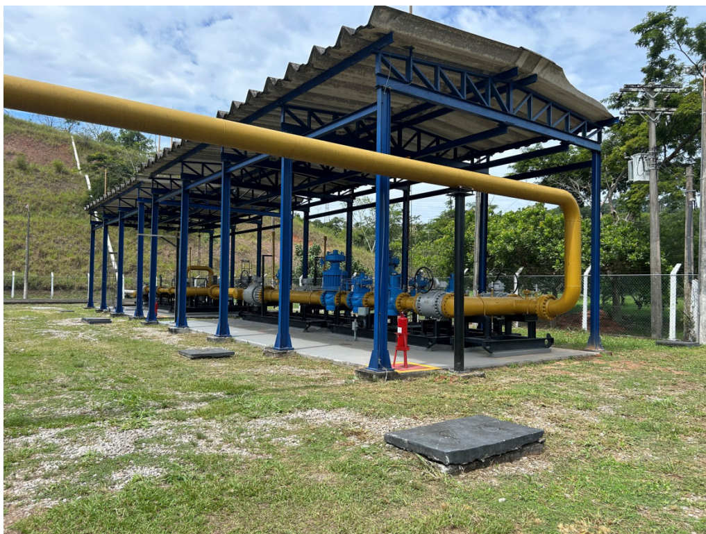
Foto 4: Entrada do gás na Estação de Regulagem e Medição.
