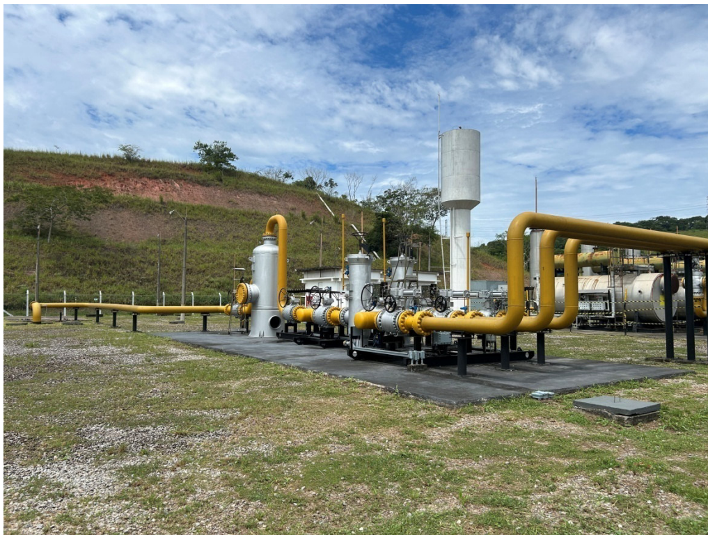
Foto 3: Direcionamento do duto para a UTE, com sistema de filtragem.
