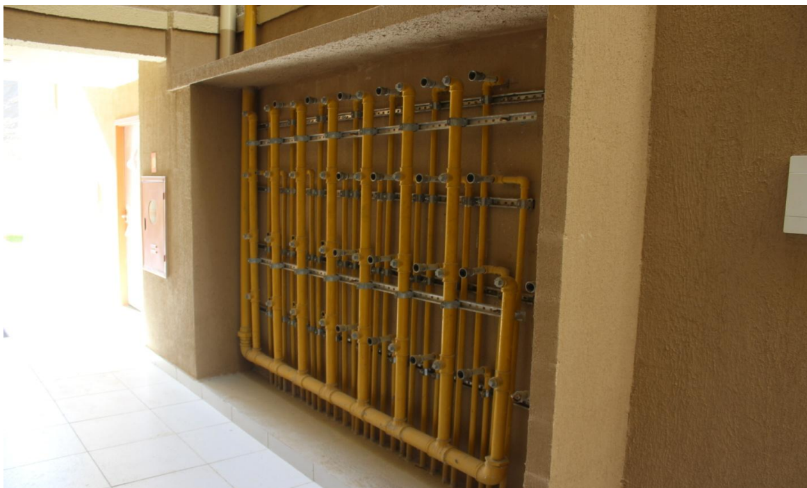
Foto 4: Cabine de medidores instaladas por Blocos.
