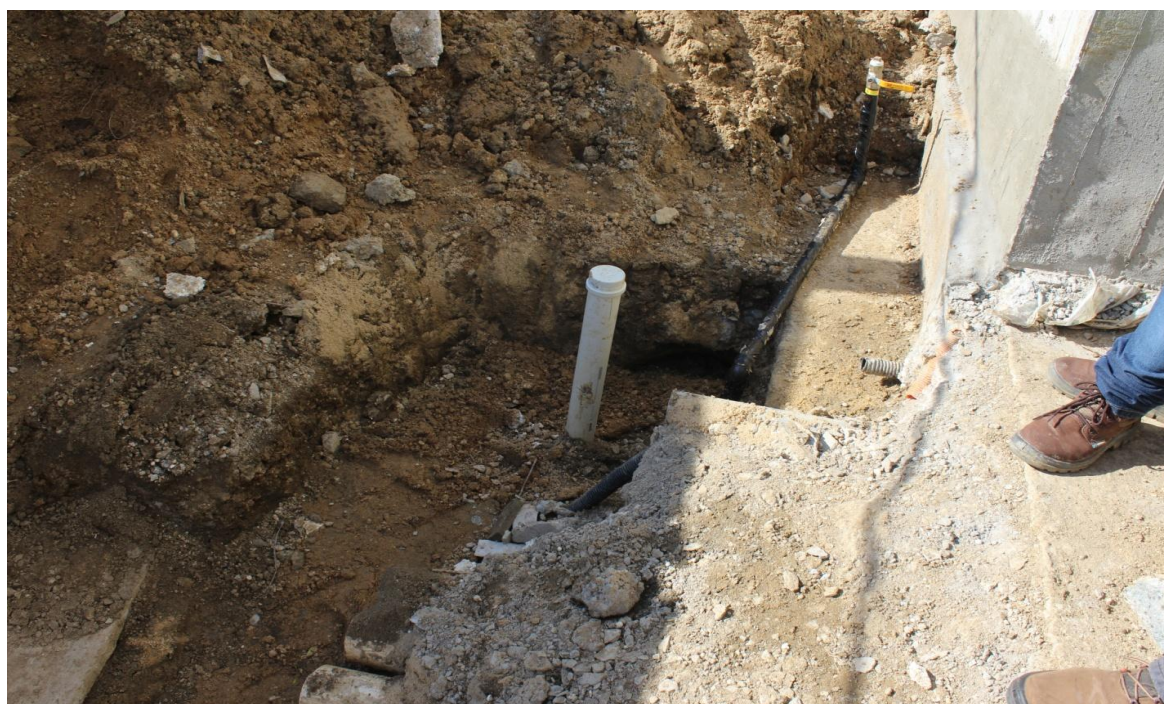
Foto 2: Ponto de instalação do regulador de pressão.
