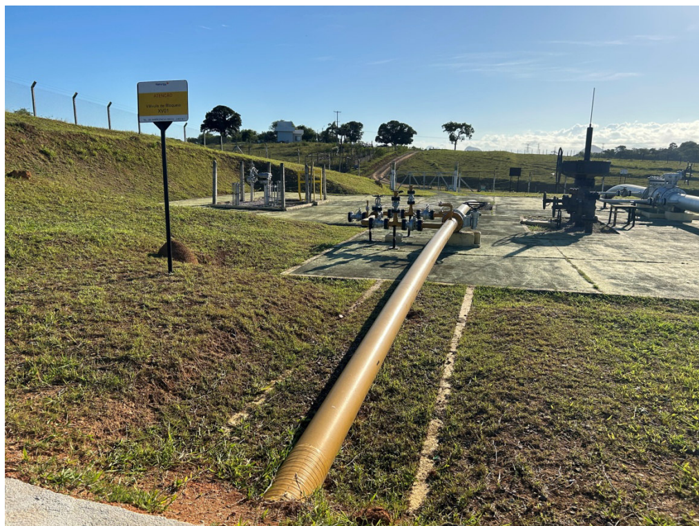
Foto 2: Placa de identificação da estação (à esquerda) e válvula da Concessionária (à direita).
