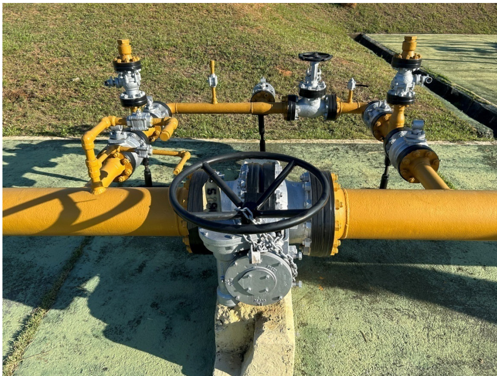
Foto 3: Válvula de bloqueio (à frente) e bypass (atrás)
