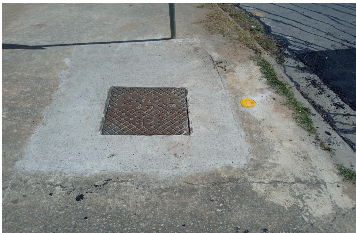
Foto 10: Caixa de válvula de rede
