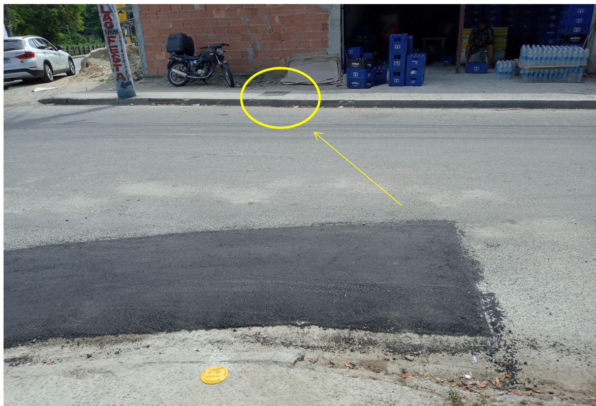
Foto 10: Caixa de válvula de rede
