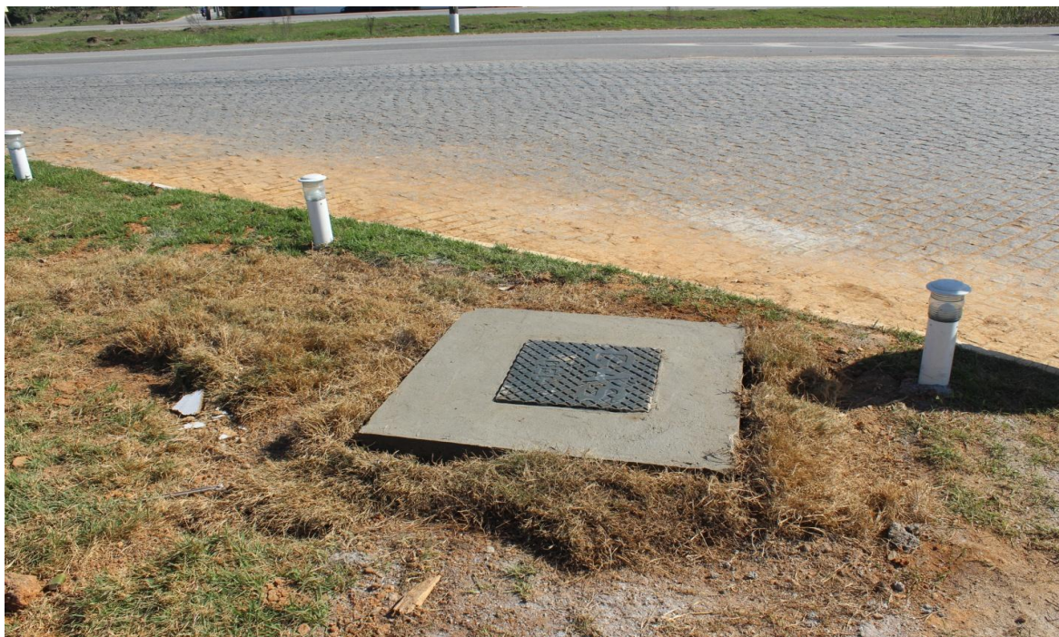
Foto 6: Caixa de válvula para abastecimento do cliente.
