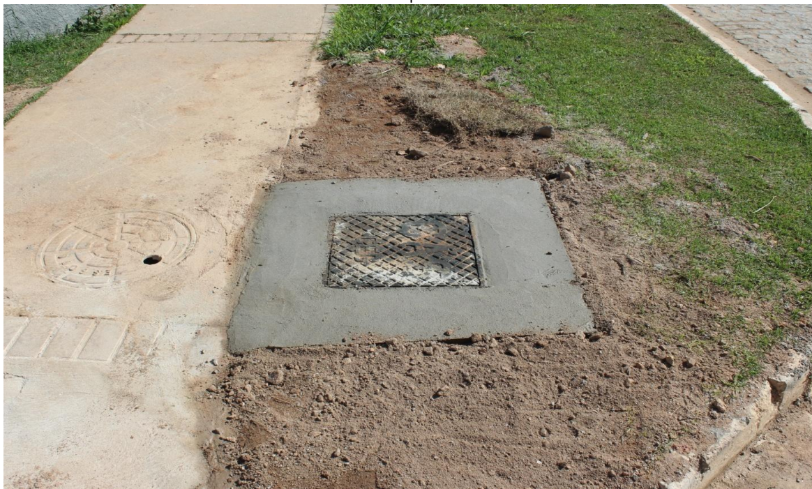
Foto 1: Caixa de válvula de interligamento de redes
