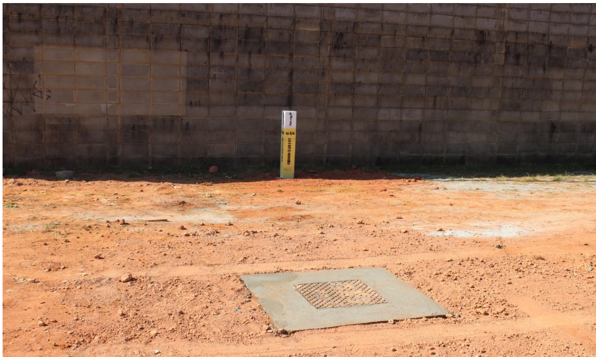
Foto 5: Caixa de válvula e marco horizontal indicando a presença de rede de Gás Natural.
