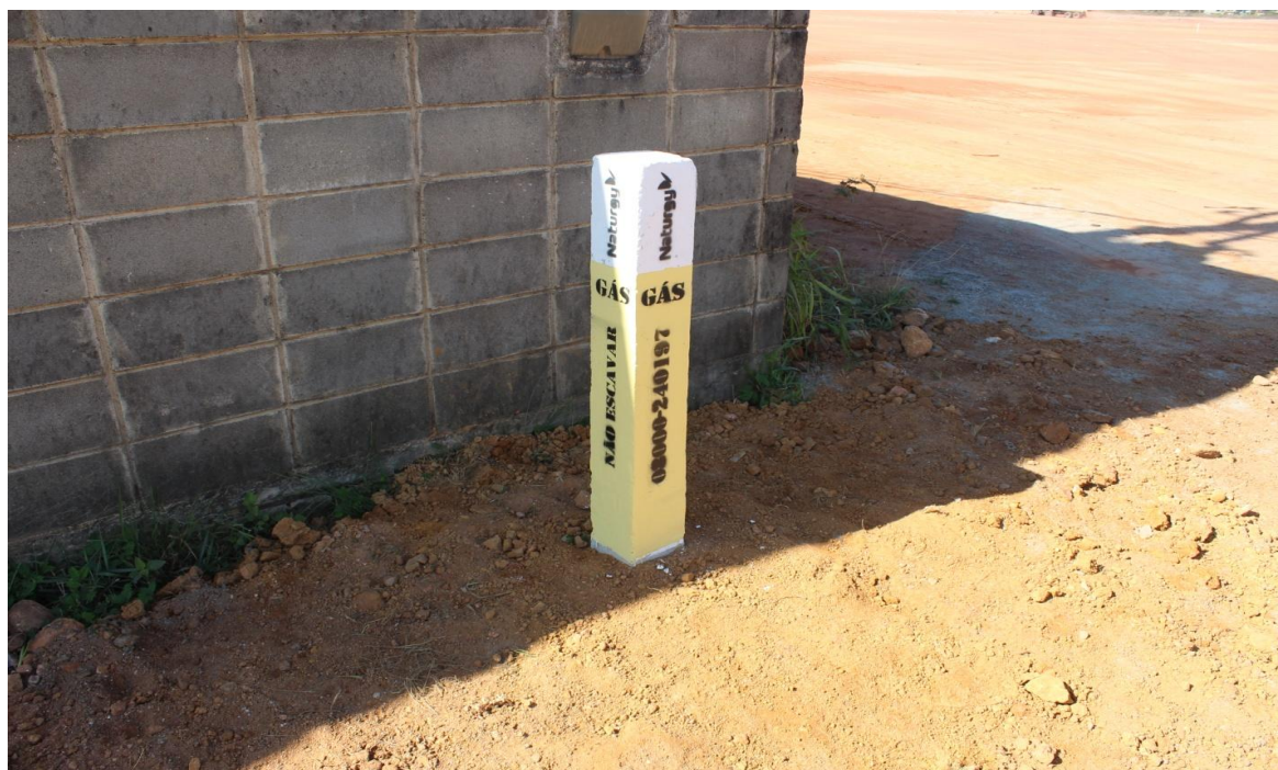
Foto 4: Marco horizontal indicando a presença de gás natural.
