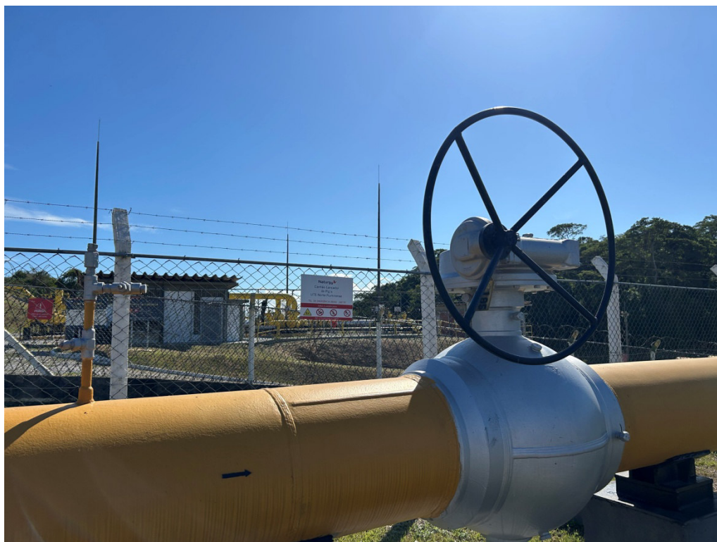
Foto 5: Canhão lançador de PIG para a UTE Norte-Fluminense e placa de identificação (ao fundo).
