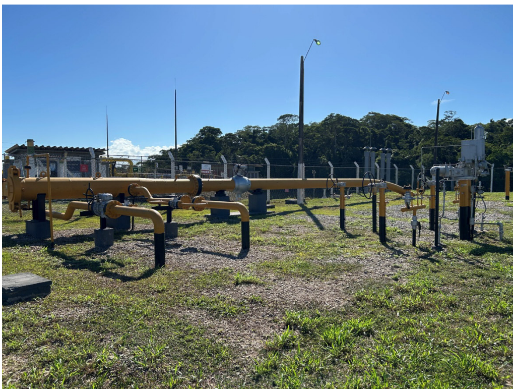
Foto 6: Canhão lançador de PIG para a UTE Norte-Fluminense e válvulas de bloqueio e manobra.
