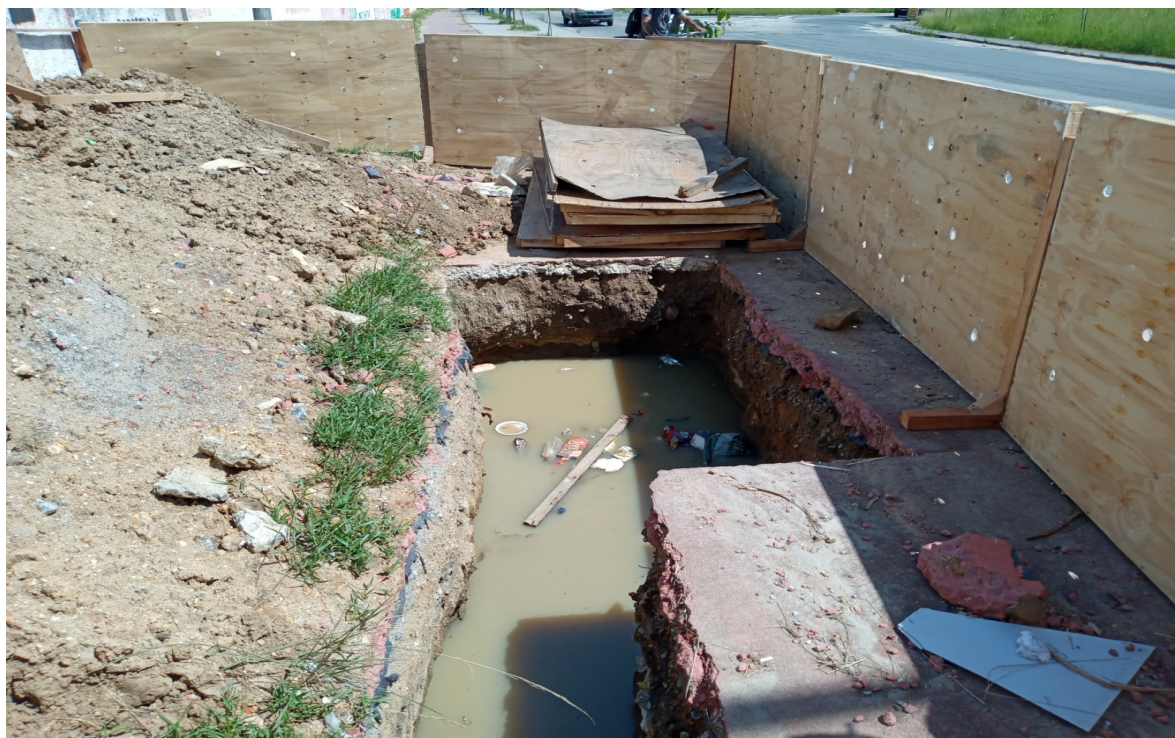
Foto 13: Tie in com água acumulada (antes)
