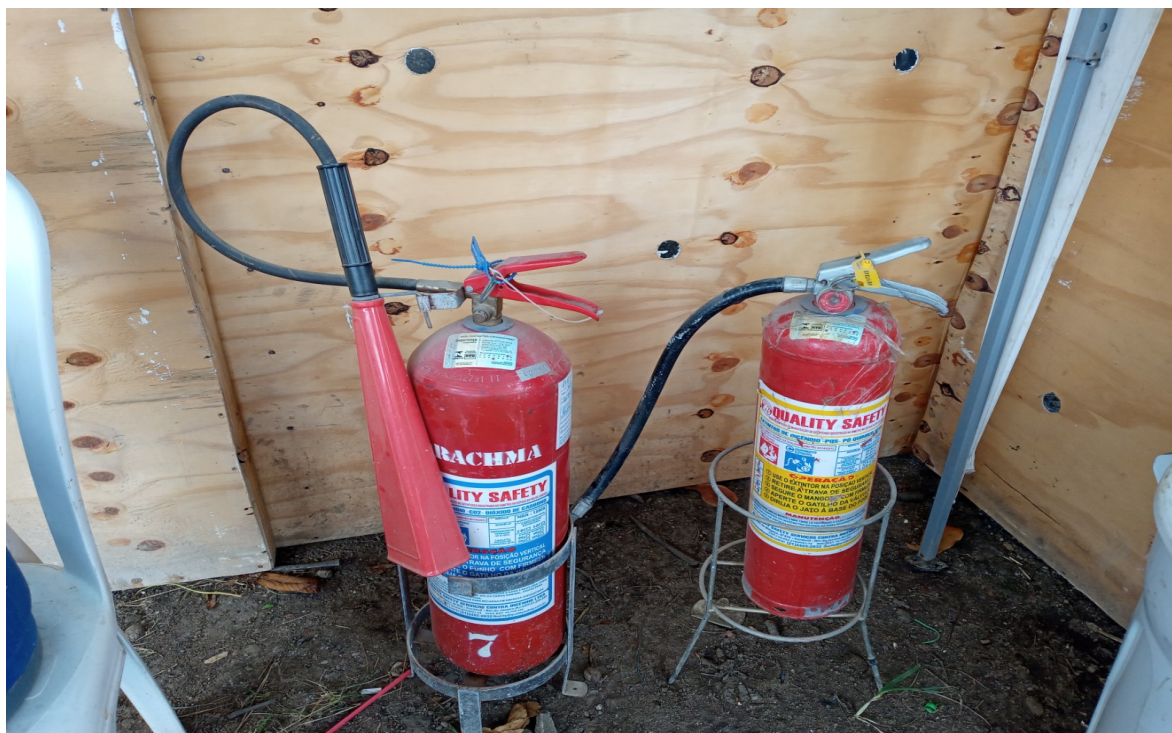
Foto 9: Extintor de CO2 e PQS
