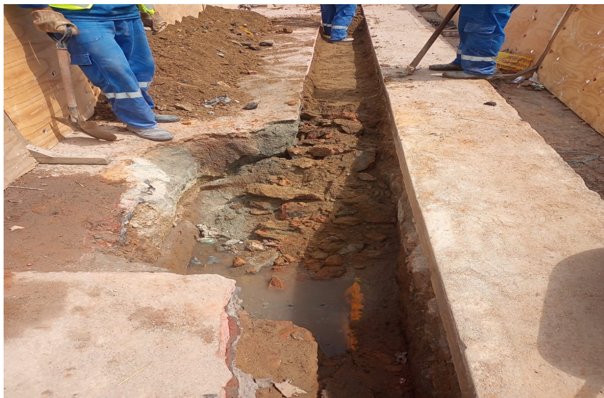
Foto 16: Tie in com água acumulada (depois)
