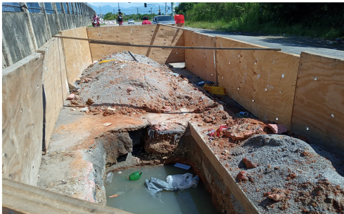
Foto 15: Tie in com água acumulada (antes)
