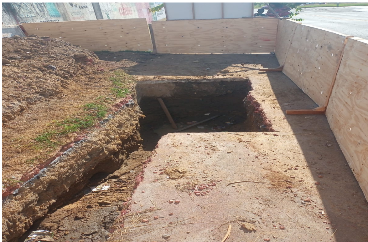
Foto 14: Tie in com água acumulada (depois)
