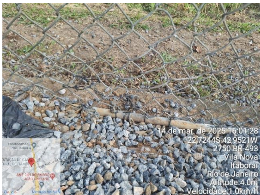
Foto 9: Foto enviada posteriormente pelo funcionário da Naturgy mostrando o buraco da cerca já reparado.
