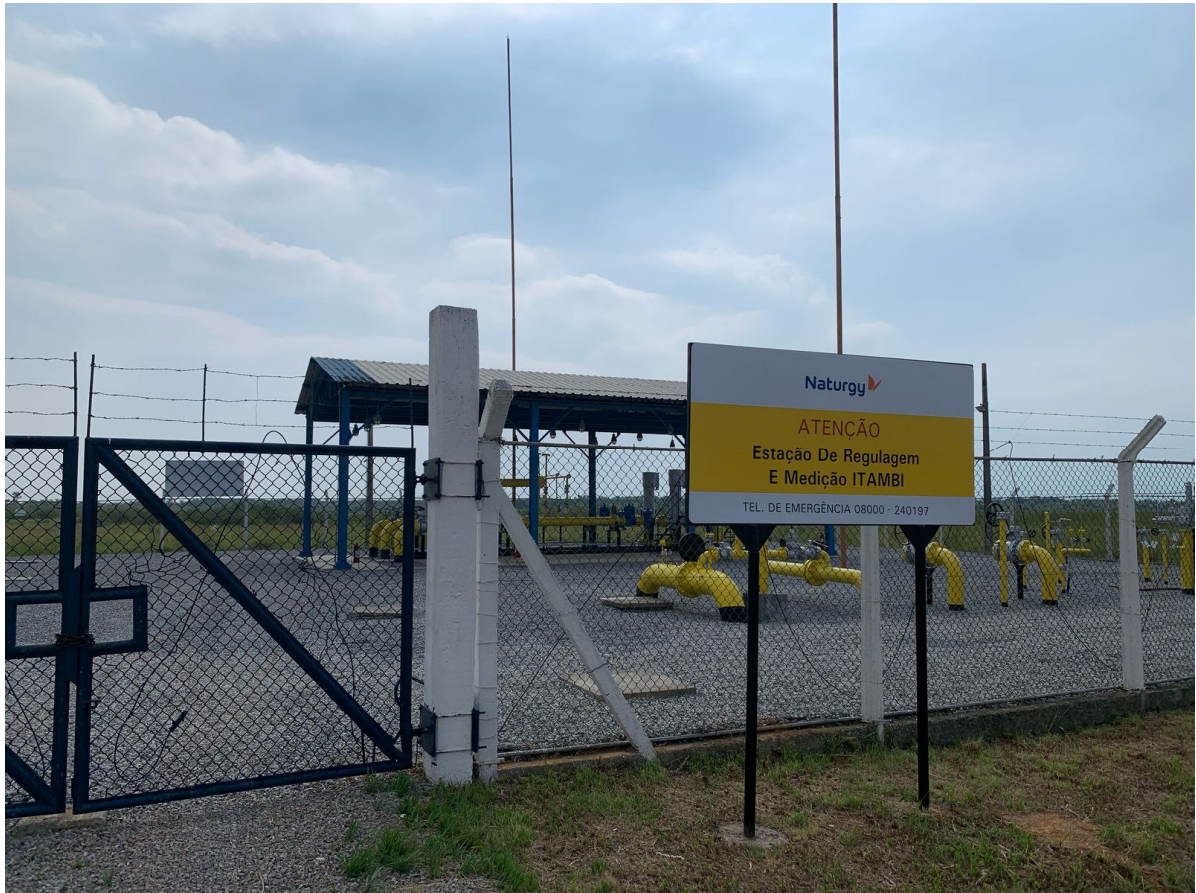
Foto 1: Placa de identificação da estação.
