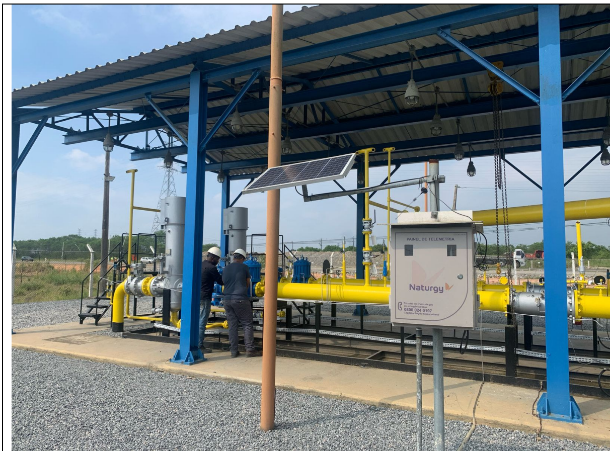
Foto 6: Visão da estação com o painel de telemetria à frente.
