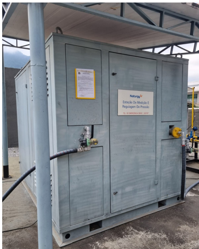
Foto 4: Unidade de Redução e Controle – RCU da estação.
