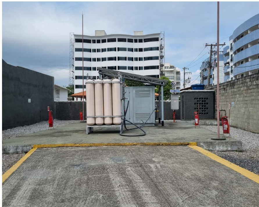
Foto 2: Visão frontal da Estação de Descompressão de Itacuruçá em Mangaratiba/RJ.
