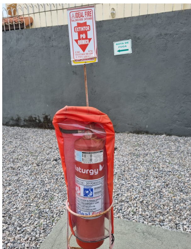
Foto 12: Extintor com proteção contra intempéries.
