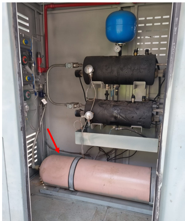
Foto 5: Unidade de Redução e Controle – RCU da estação, com destaque para o cilindro horizontal.
