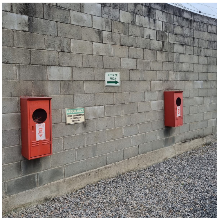
Foto 11: Sinalização de rota de fuga e extintores com proteção contra intempéries.
