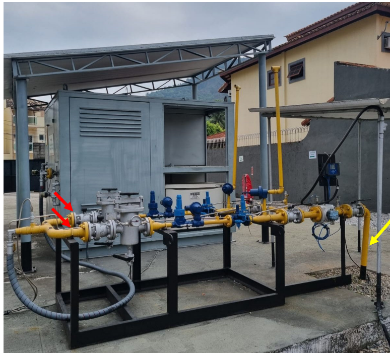
Foto 8: Estação de regulação e medição, com destaque para as duas linhas do sistema (setas vermelhas) e para a tubulação de distribuição subterrânea (seta amarela).
