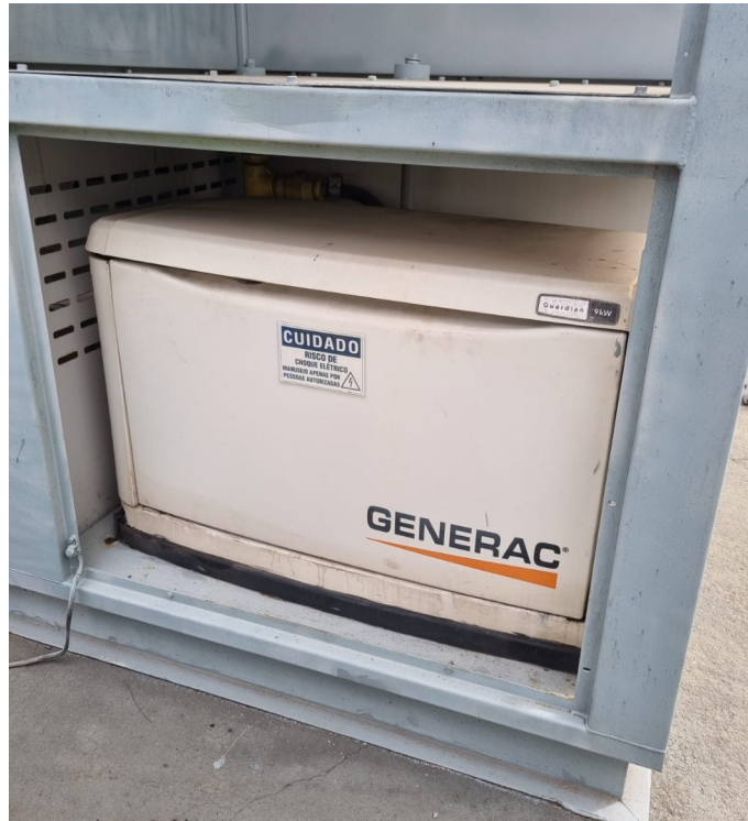
Foto 9: Gerador a gás da estação localizado dentro da RCU.
