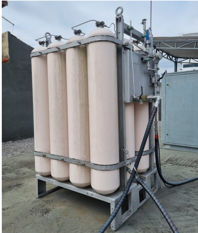
Foto 3: Sistema de estocagem de GNC composto por 16 cilindros verticais.
