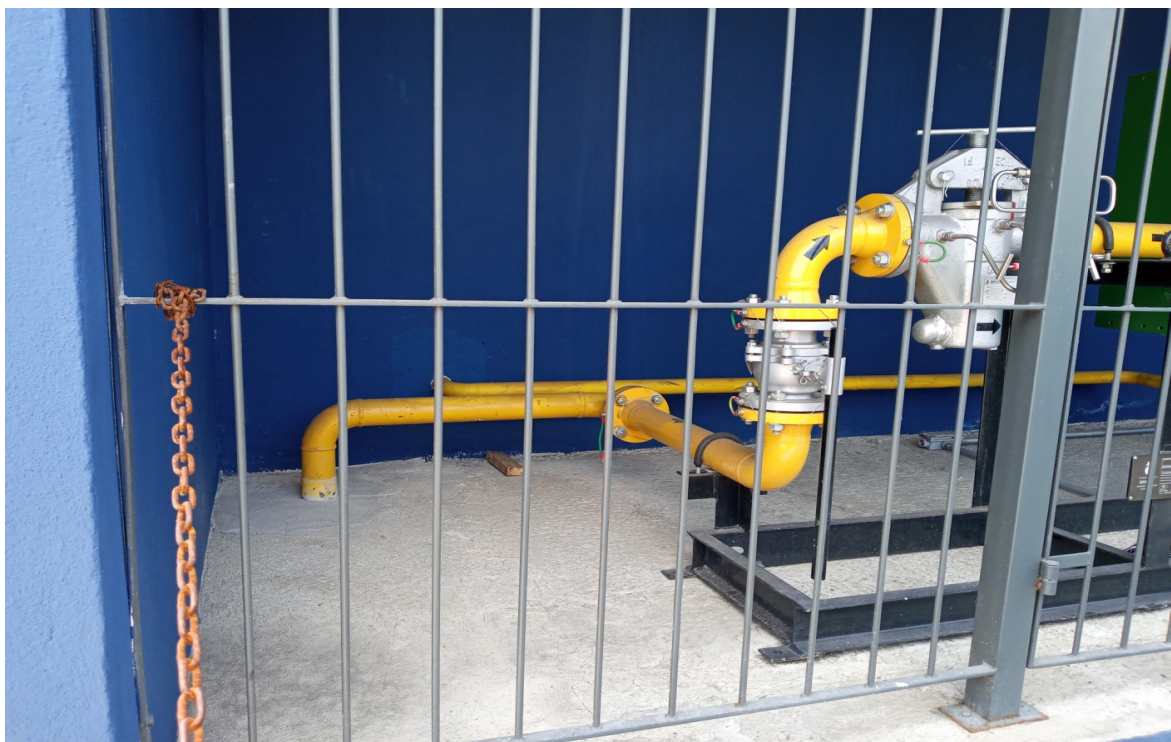
Foto 8: Tubulação de entrada de gás na estação de medição
