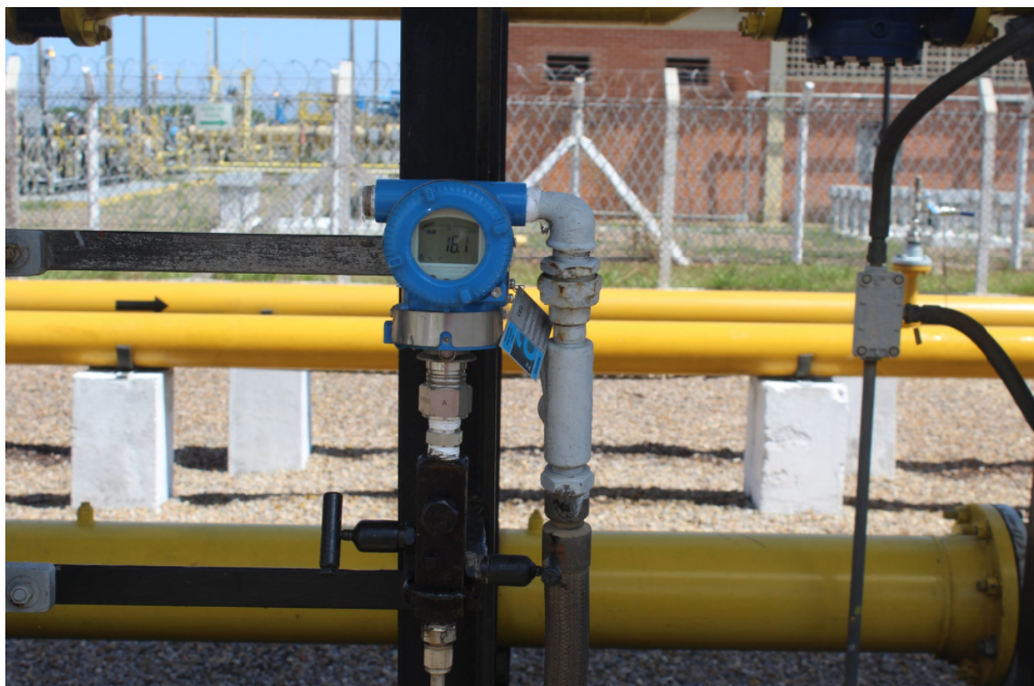
Foto 7: Manômetro de saída
