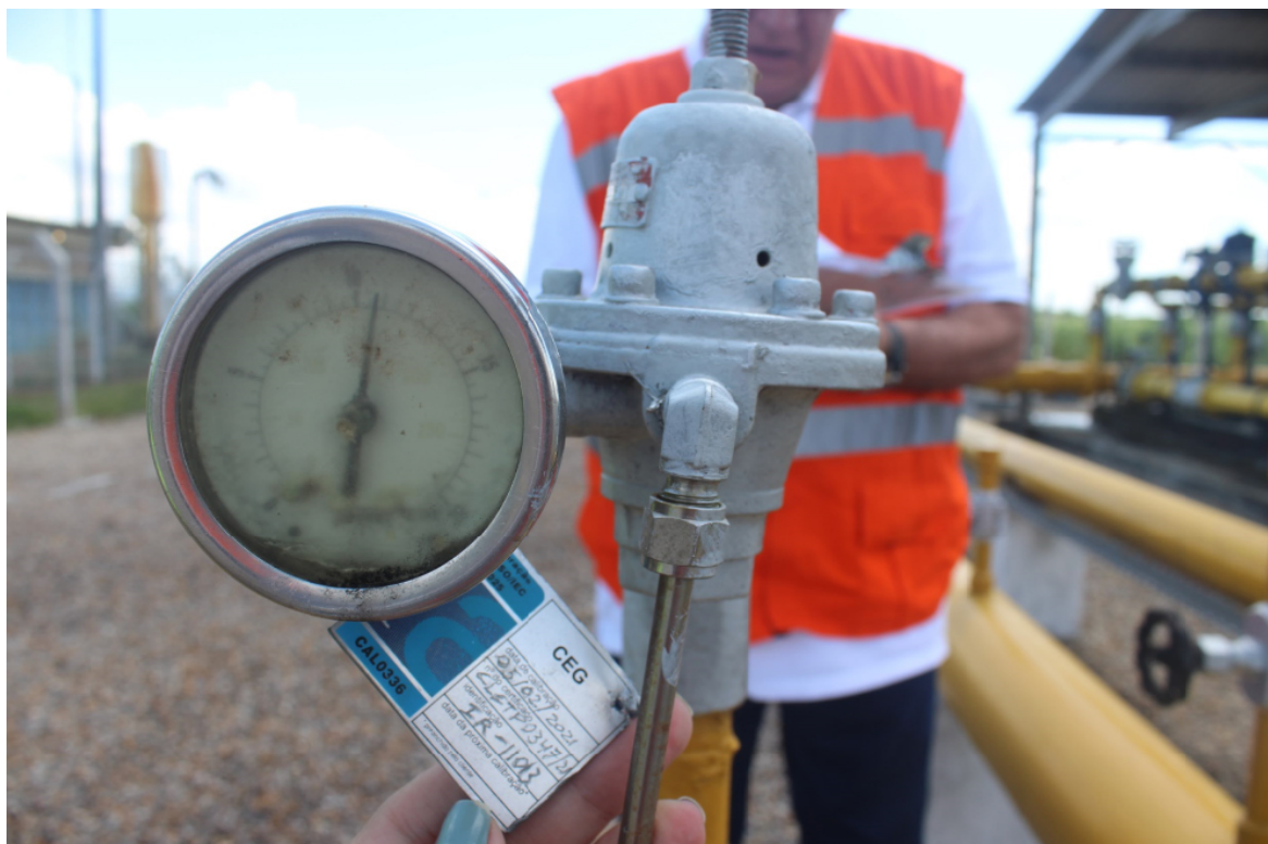
Foto 12: manômetro com defeito
