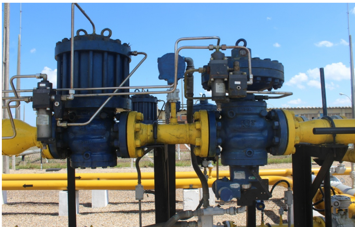
Foto 6: Sistema de regulação
