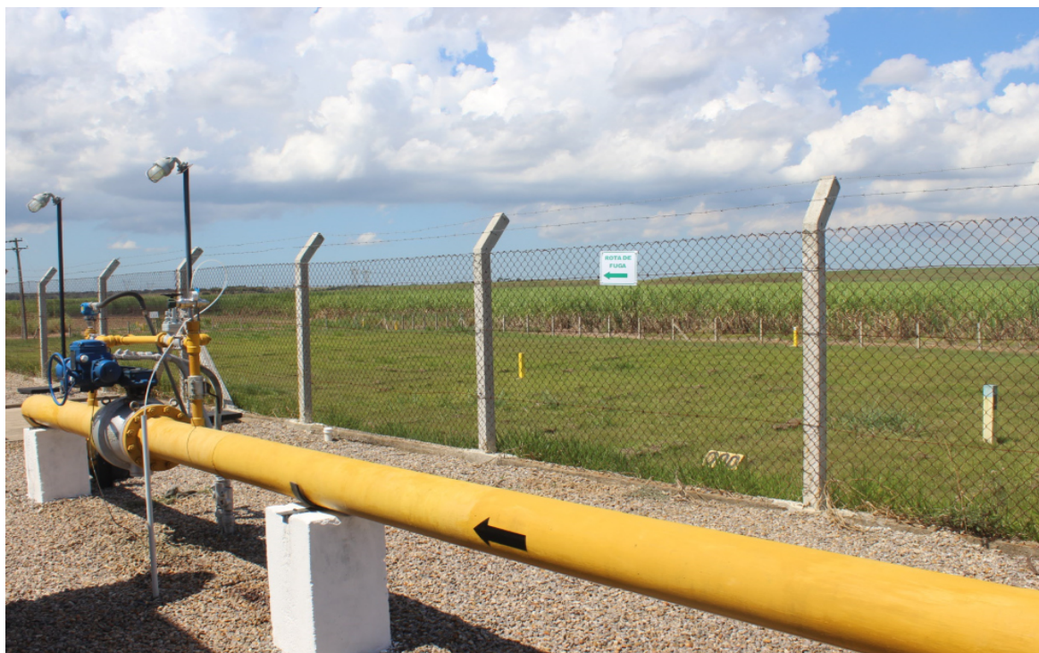
Foto 13: Sinalização do fluxo de gás e rota de fuga
