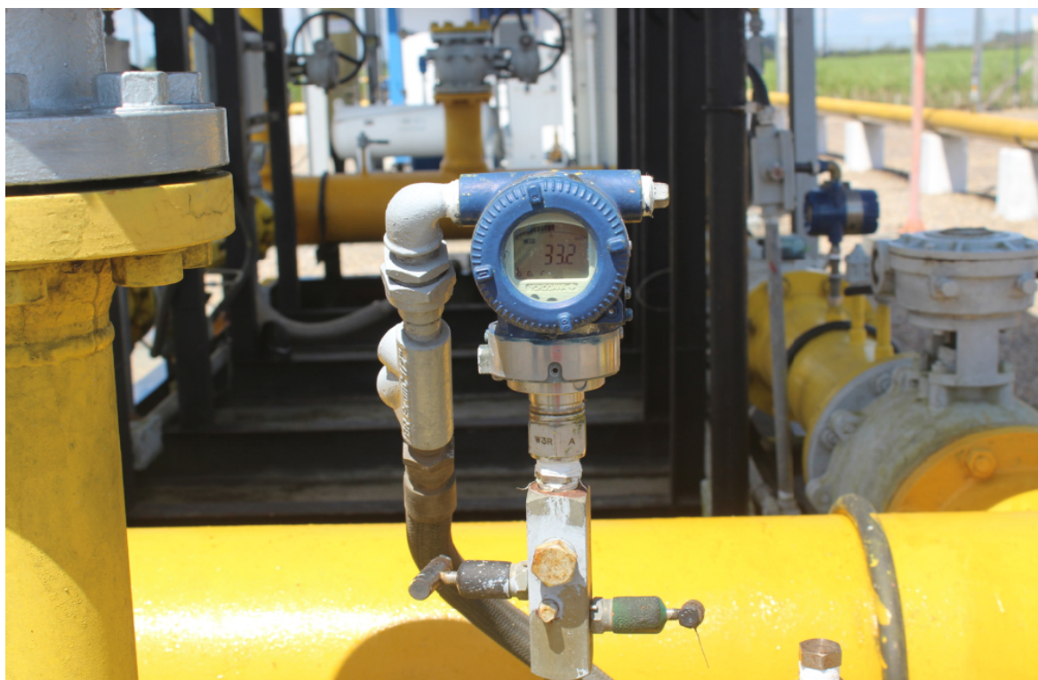
Foto 5: Manômetro de entrada
