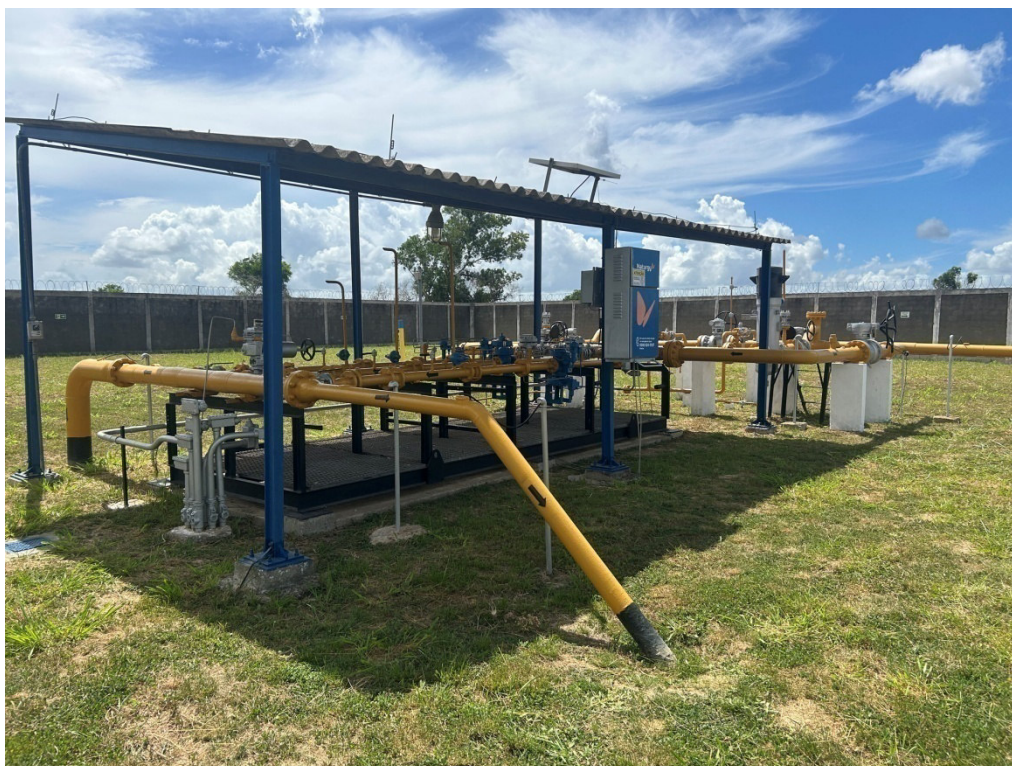
Foto 2: Vista da estação aérea de gás.
