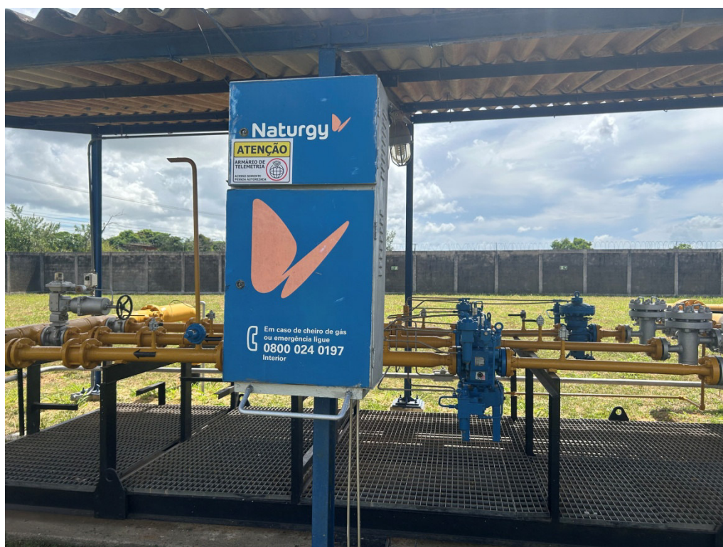
Foto 6: Sistema de telemetria da estação.
