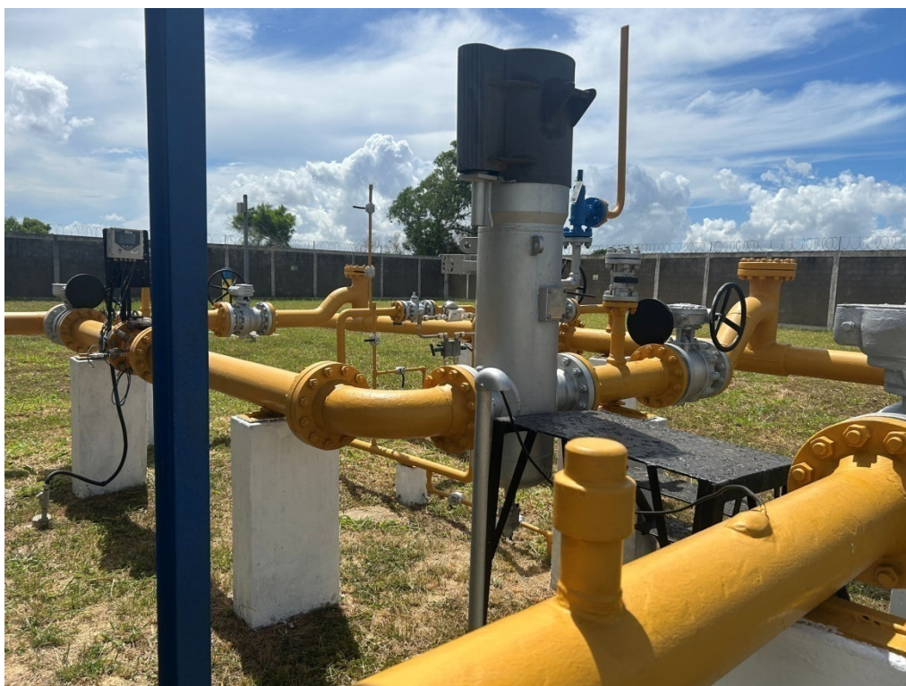
Foto 4: Estação aérea de Tapera e medidor.
