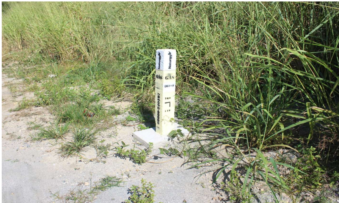
Foto 3: Marco horizontal indicando a presença de rede de Gás Natural.
