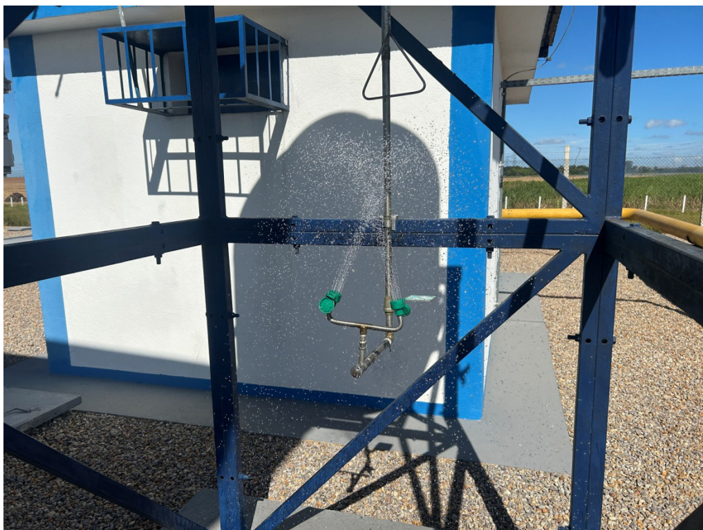
Foto 6: Lava-olhos do chuveiro em funcionamento.
