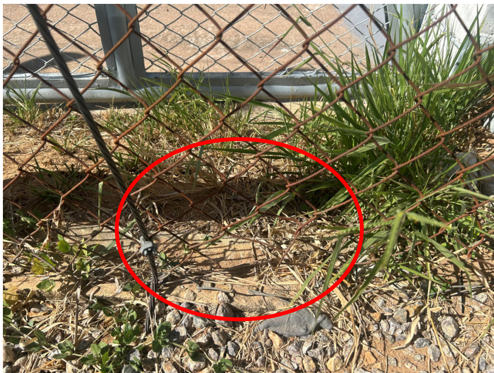
Foto 11: Falha visível na cerca.
