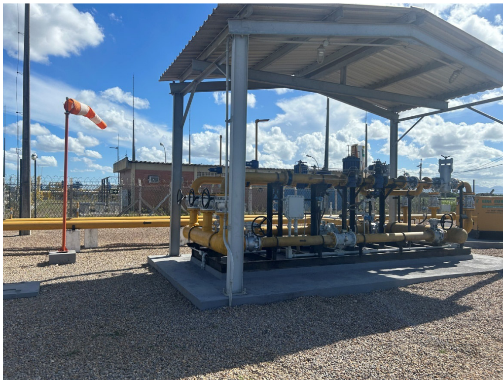
Foto 2: Vista da estação de regulagem e medição.
