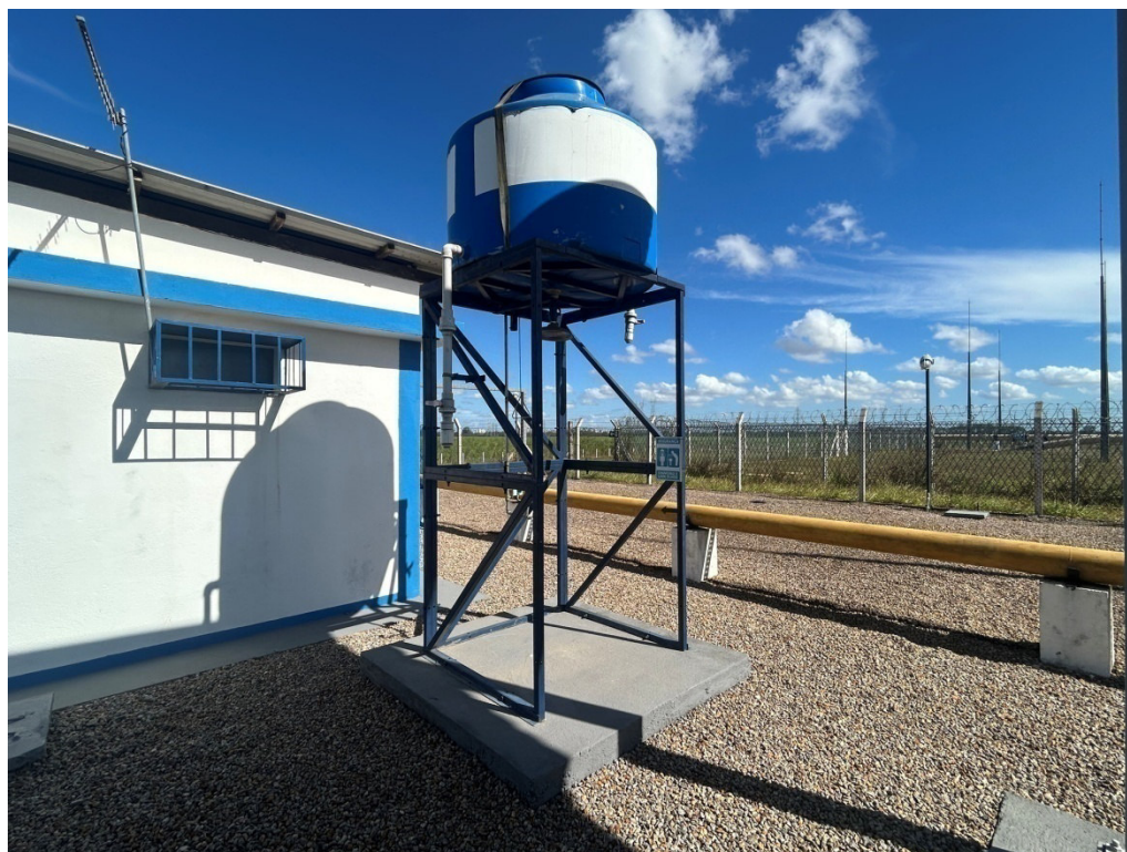
Foto 5: Chuveiro de emergência.
