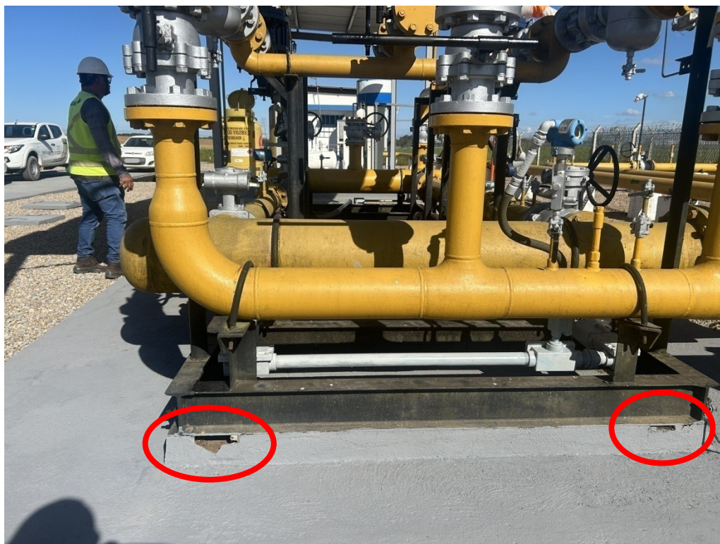
Foto 9: Desgastes visíveis na base de concreto sob a estação de regulagem e medição.
