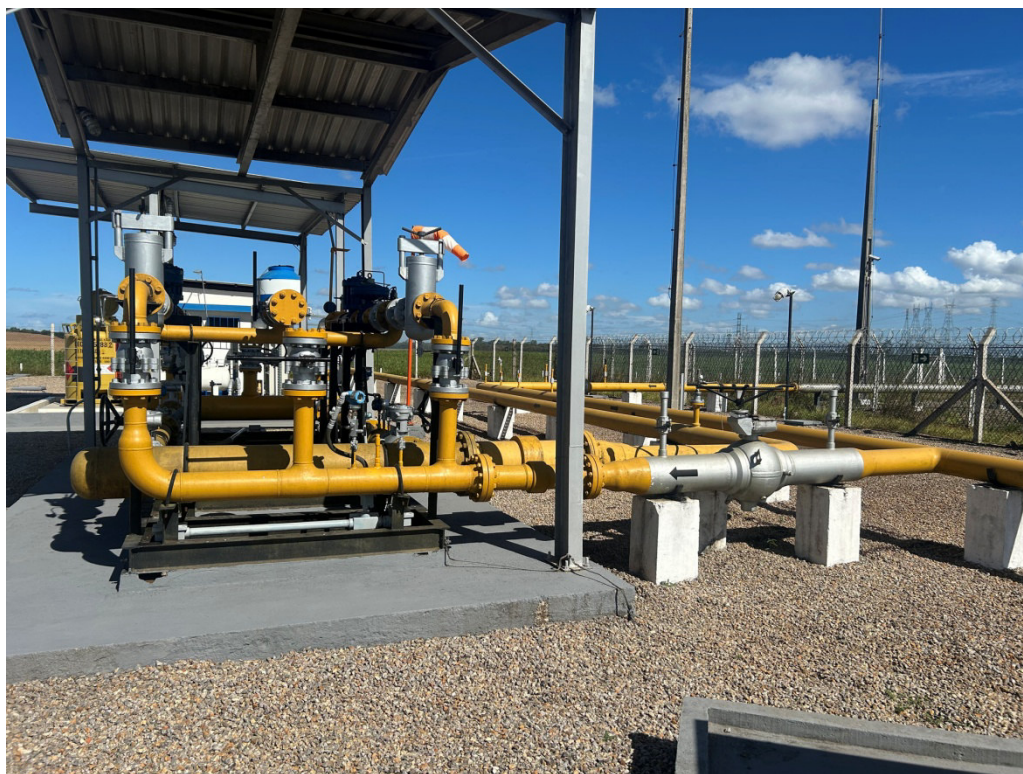
Foto 3: Estação de regulação e medição, que se conecta ao ponto de entrega da TAG pelo gasoduto à direita.
