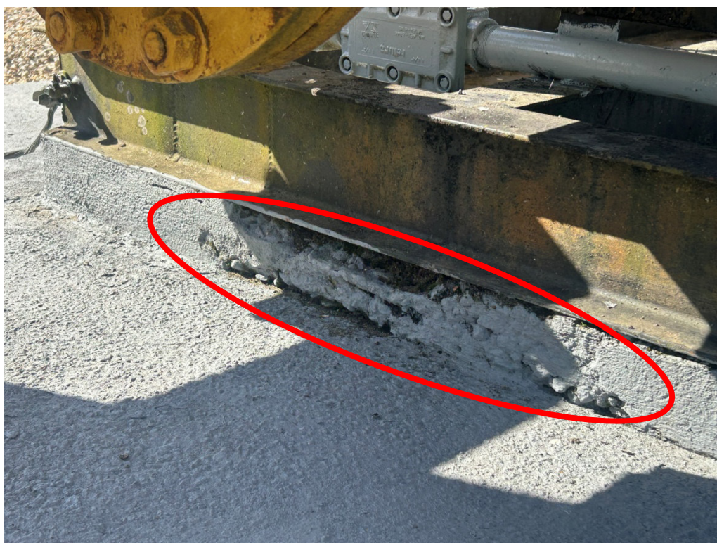
Foto 10: Desgaste visível na base de concreto sob a estação de regulagem e medição.
