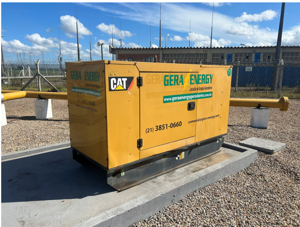
Foto 8: Gerador de energia.
