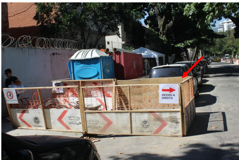
Foto 8: Isolamento de obra sem sinalização noturna.
