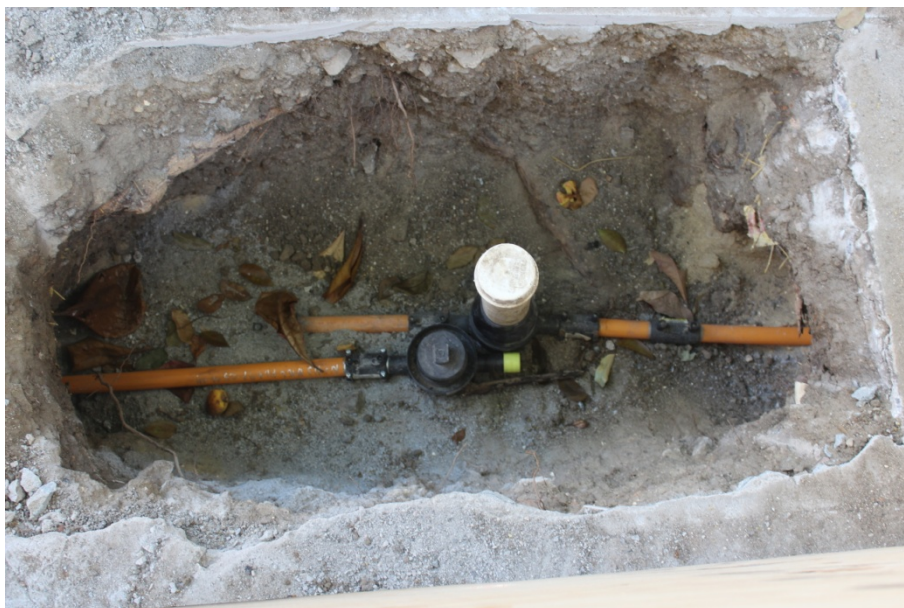
Foto 10: Ramal de PE Ø32 mm e válvula de bloqueio do ramal
