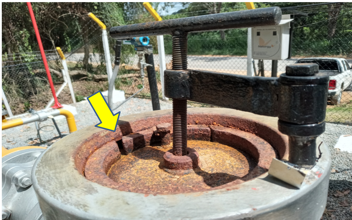
Foto 9: Parte superior do filtro apresentando corrosão
