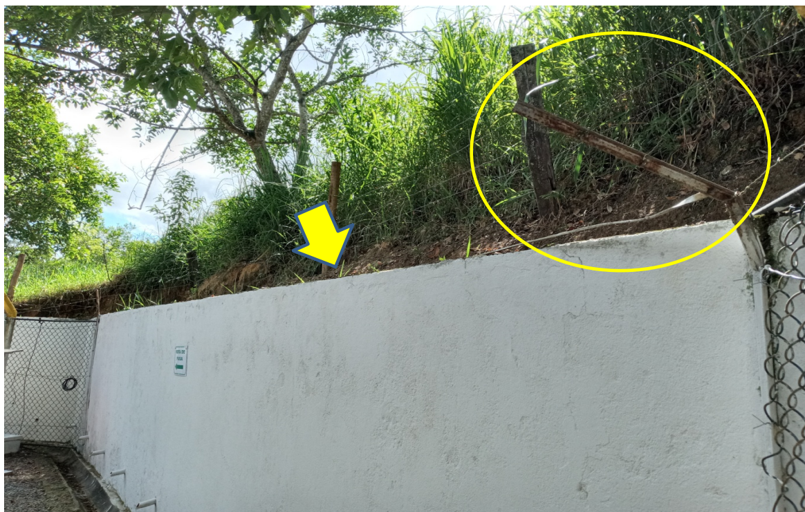
Foto 8: Ausência de cercamento sobre o muro e elemento de fixação do arame enferrujado
