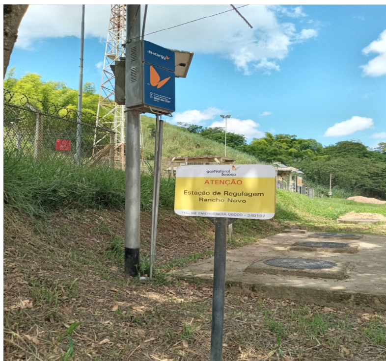
Foto 14: Estação Subterrânea de Reglagem
