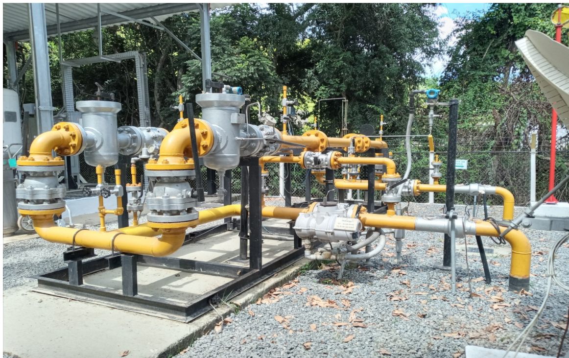
Foto 3: Estação de medição
