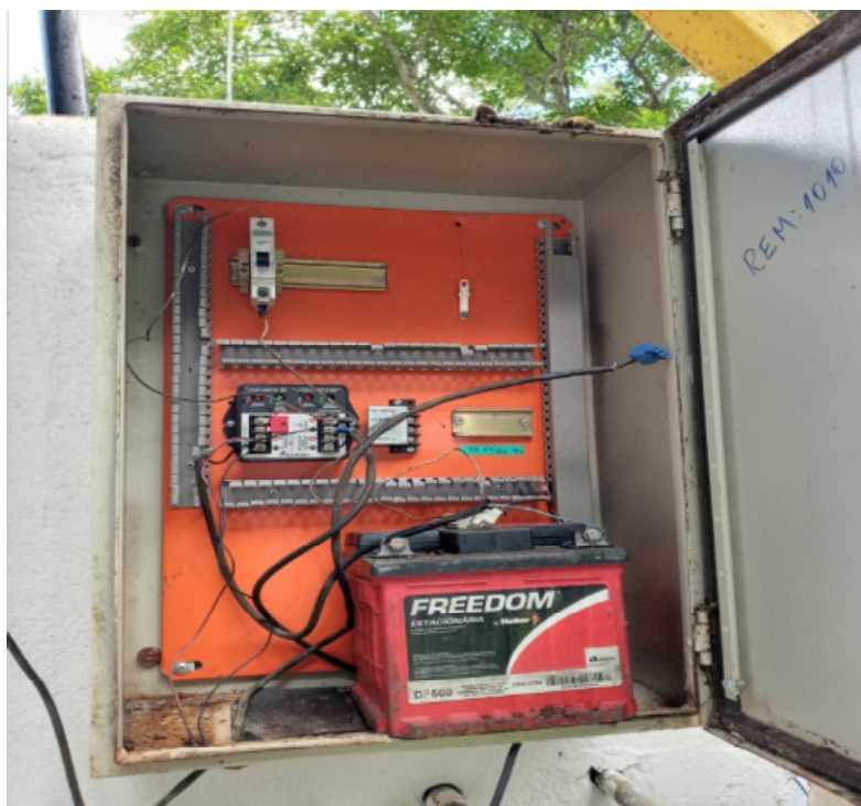
Foto 12: Painel de bateria estacionária
