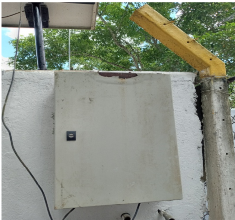
Foto 11: Painel de bateria estacionária apresentando corrosão
