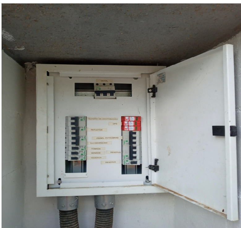
Foto 10: Quadro Geral de Distribuição
