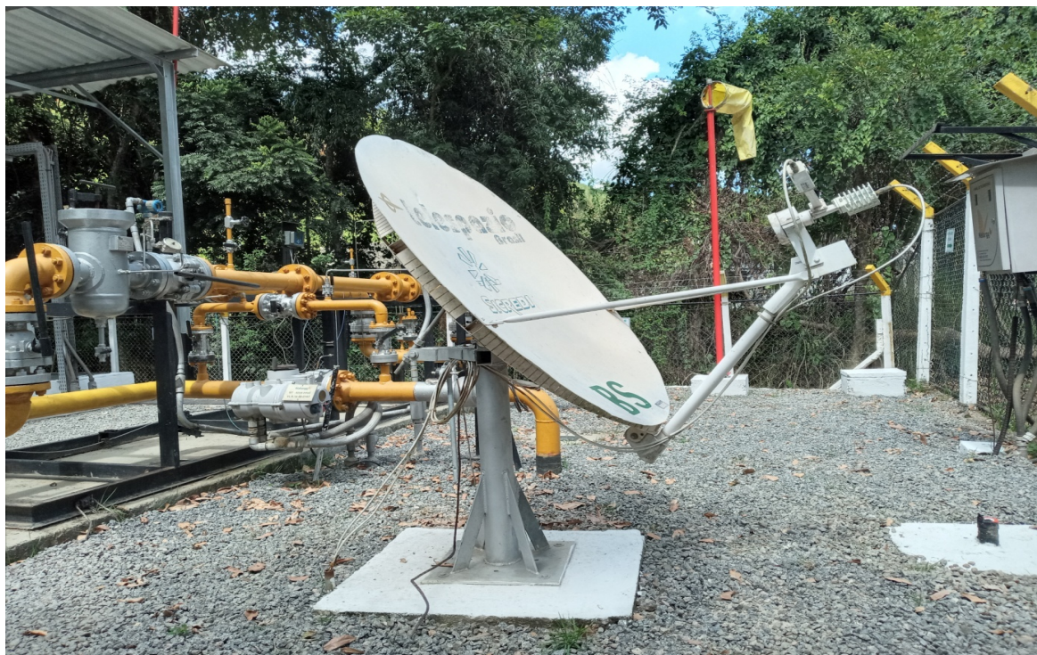
Foto 5: Antena do sistema de válvula telecomanda
