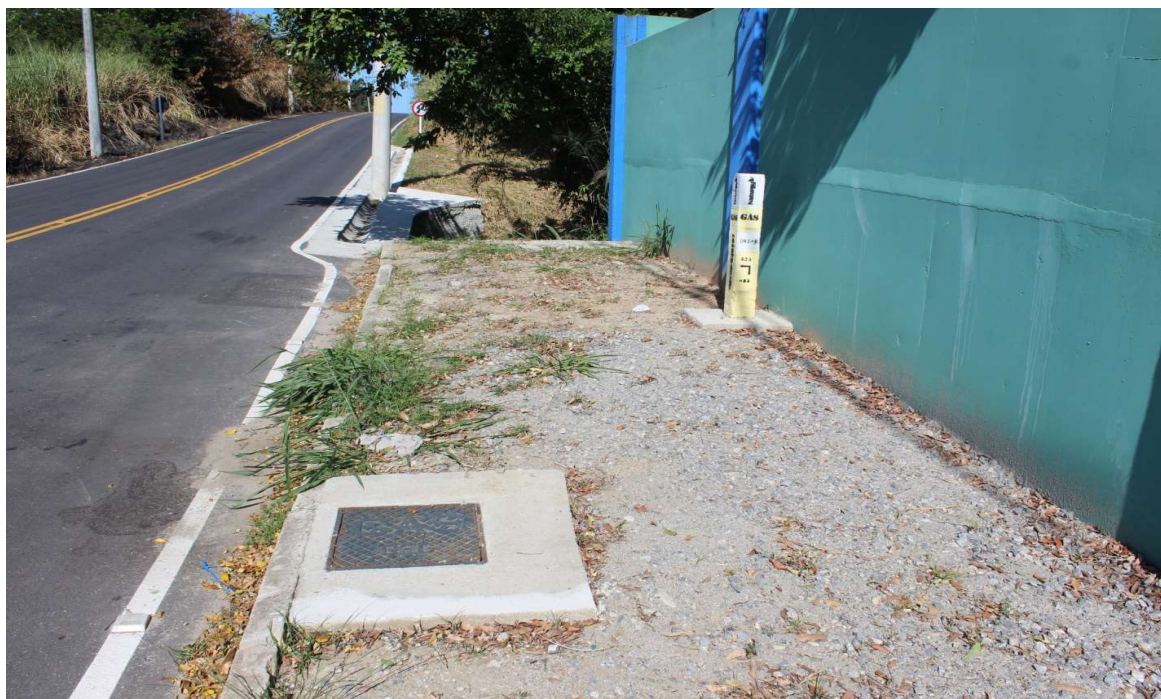
Foto 4: Caixa de válvula de entrega ao cliente e marco horizontal indicando a presença de rede de Gás Natural.
