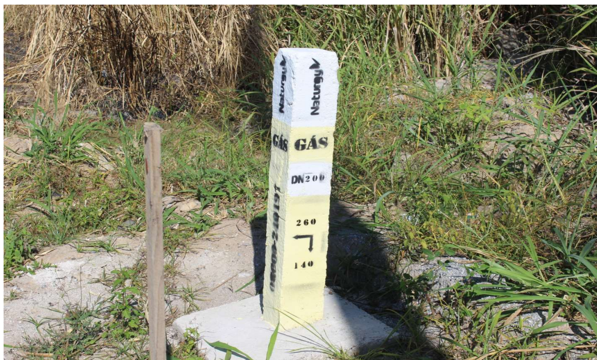
Foto 2: Marco horizontal indicando a presença de rede de Gás Natural.
