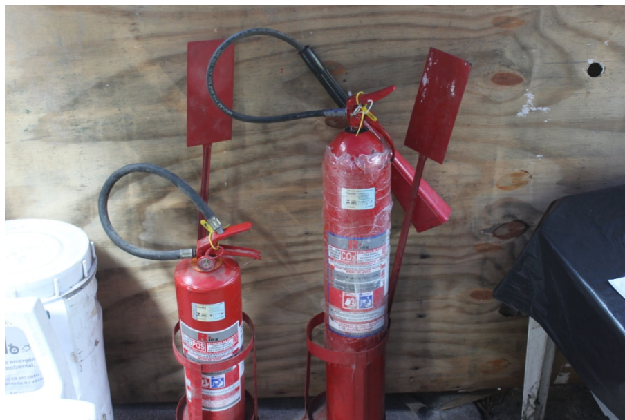
Foto 6: Extintores de incêndio presentes no local de vivência.
