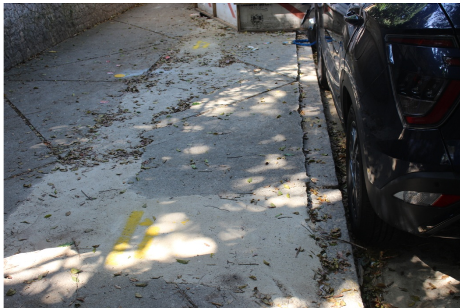
Foto 2: Recomposição provisória no passeio (lado par)
