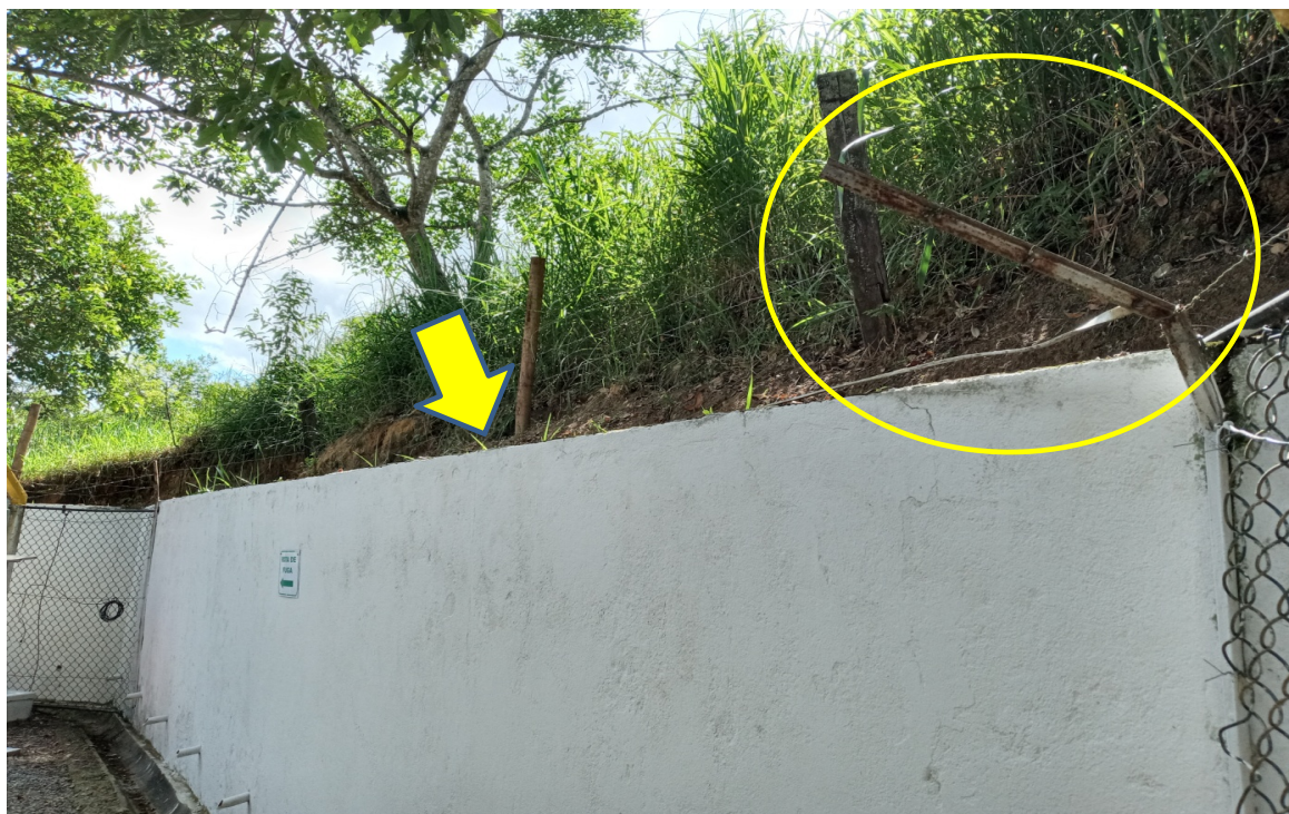
Foto 11: Ausência de cercamento sobre o muro e elemento de fixação do arame enferrujado
