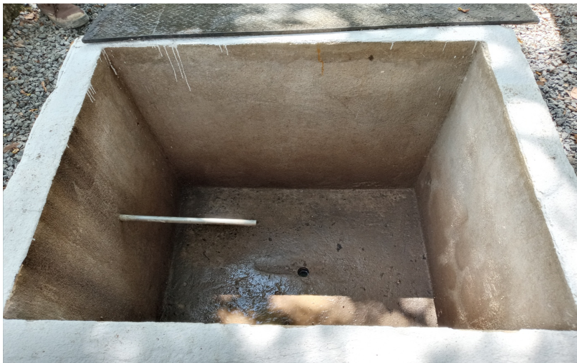
Foto 7: Caixa seca destinada a armazenar Mercaptana em caso de vazamento
