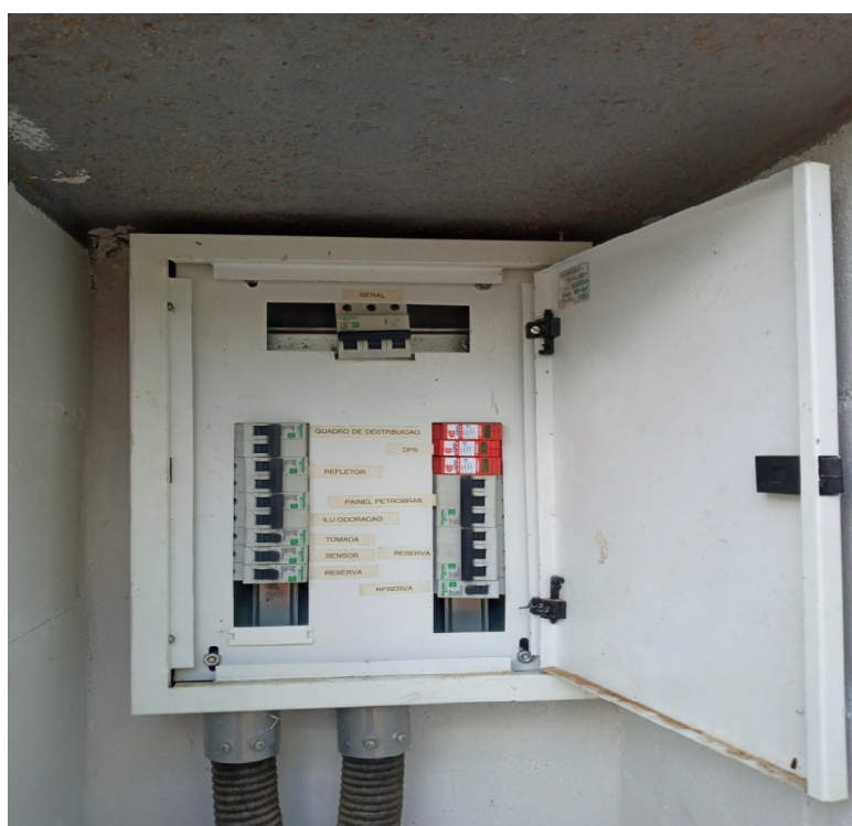
Foto 13: Quadro Geral de Distribuição
