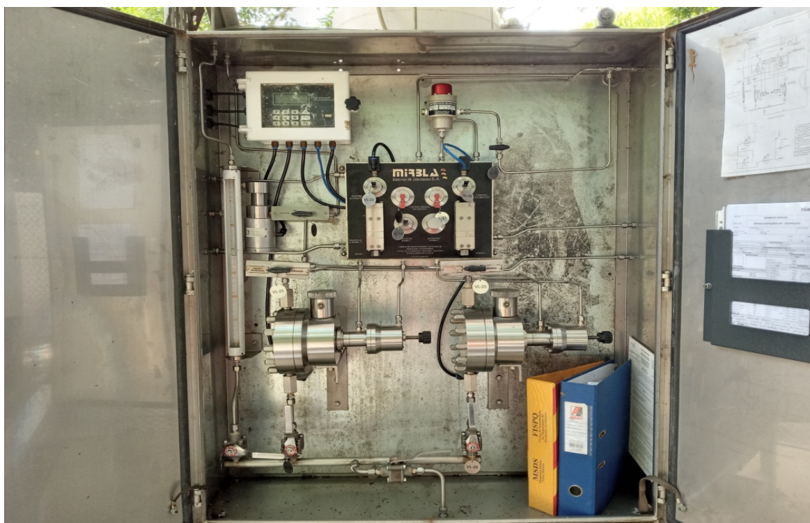
Foto 6: Equipamento de Odorização
