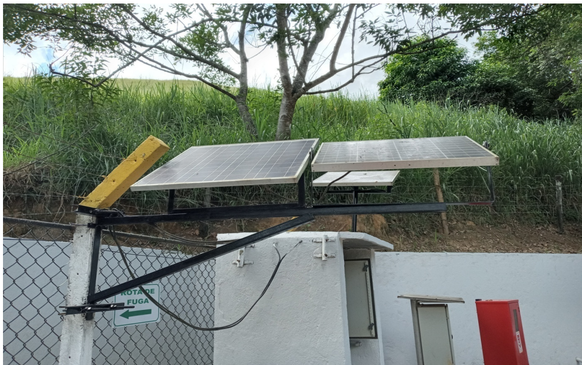
Foto 5: Painéis fotovoltaicos para sistema de Odorização e Telemetria
