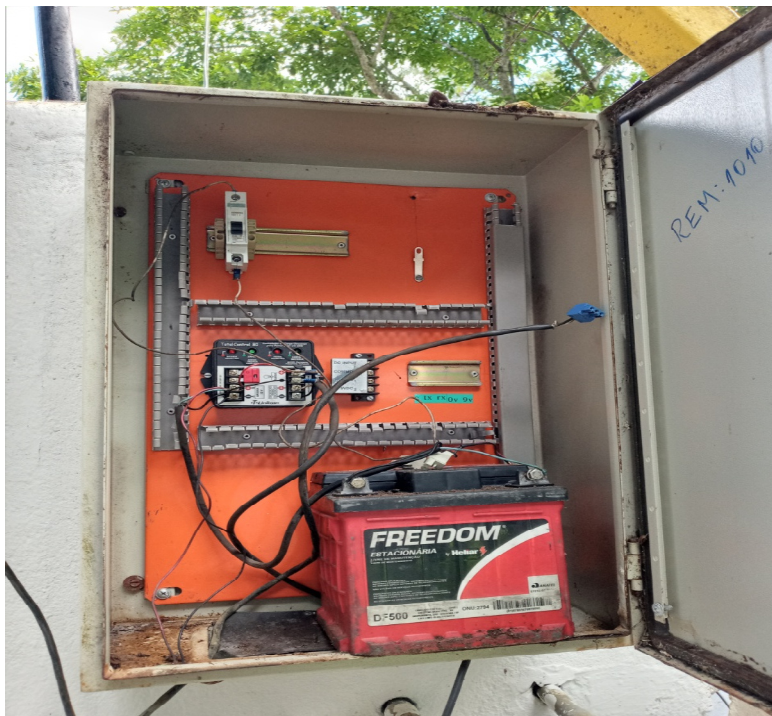
Foto 13: Pannel de bateria estacionária
