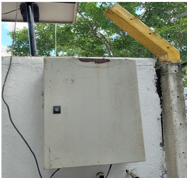
Foto 12: Painel de bateria estacionária apresentando corrosão
