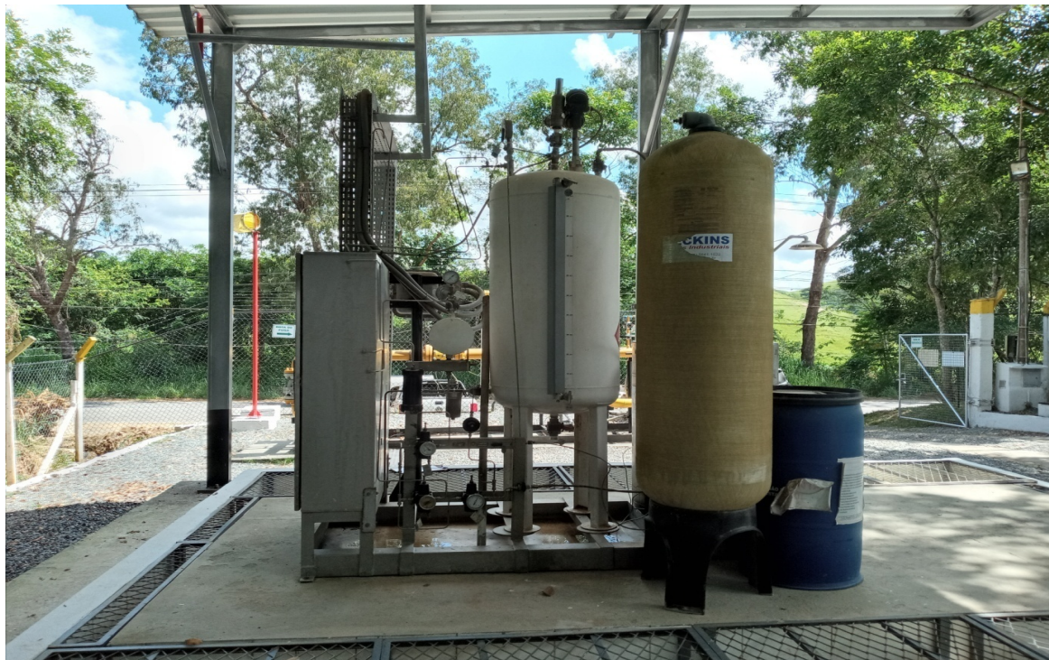
Foto 3: Estação de Odorização
