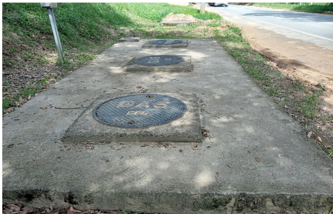
Foto 10: Estação Subterrânea de Regulação
