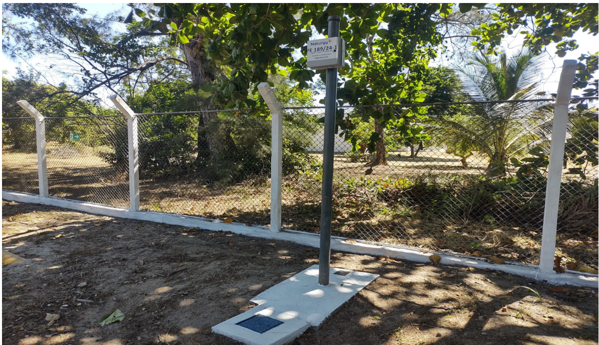
Foto 6: Ponto de teste de proteção catódica.
