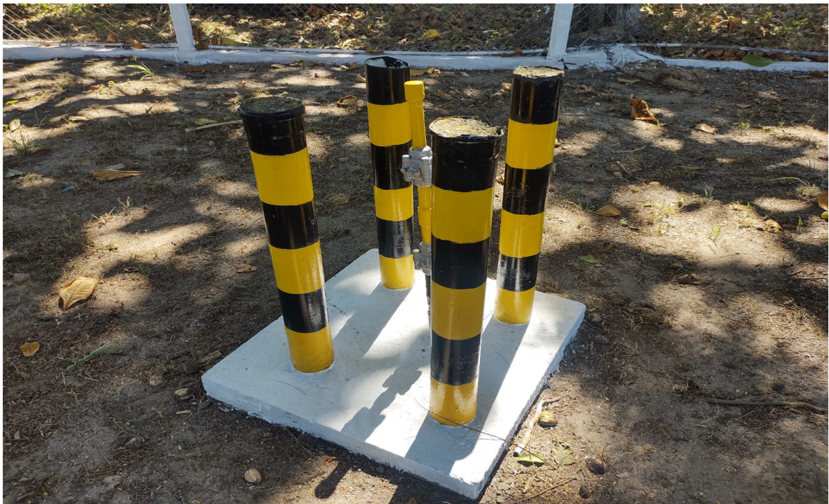
Foto 4: Ponto de teste de pressão.
