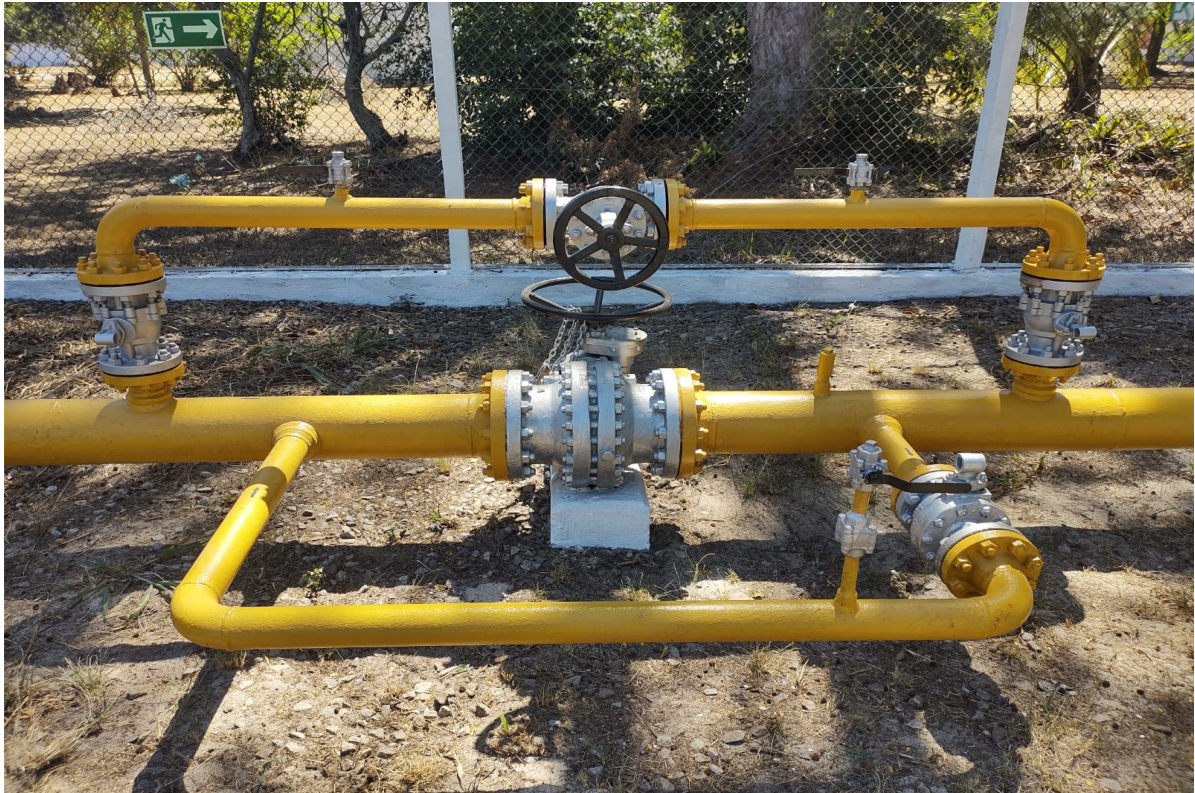
Foto 3: Válvula de Bloqueio e válvula secundária.
