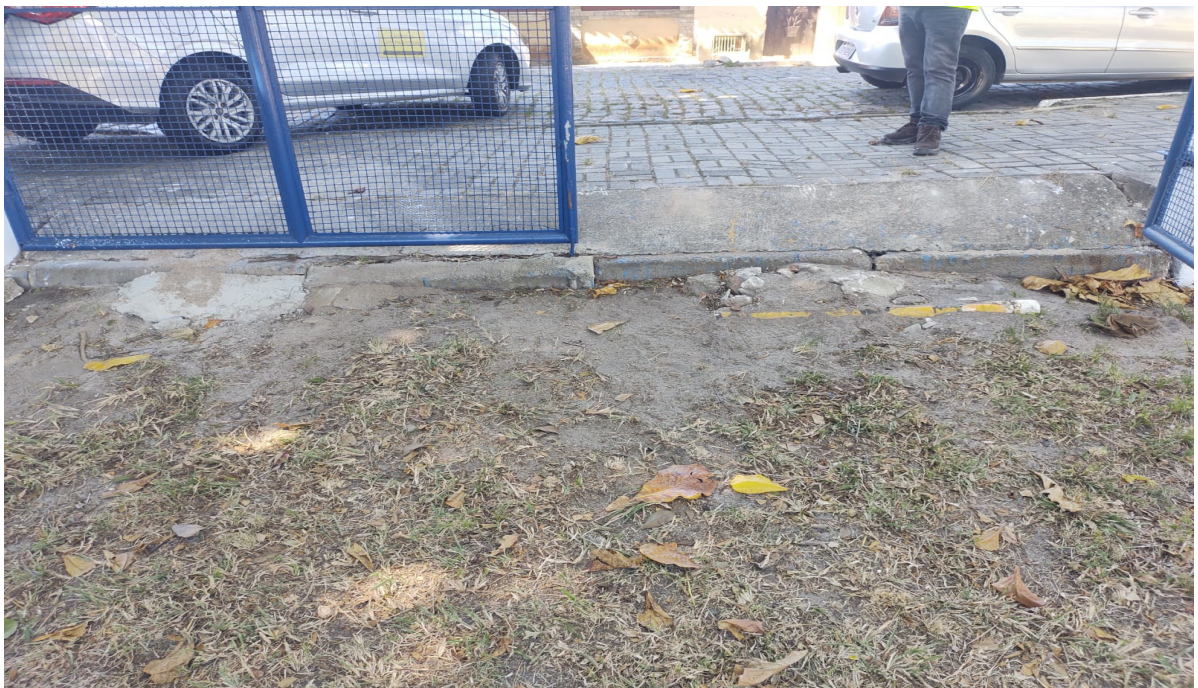
Foto 8: Piso de acesso danificado e desnivelado.
