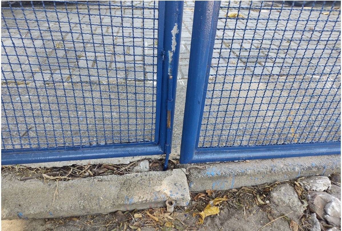
Foto 7: Suporte do portão danificado.
