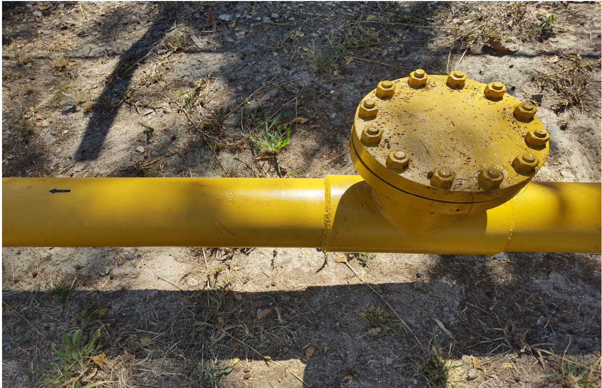
Foto 5: Conexão T de bloqueio.
