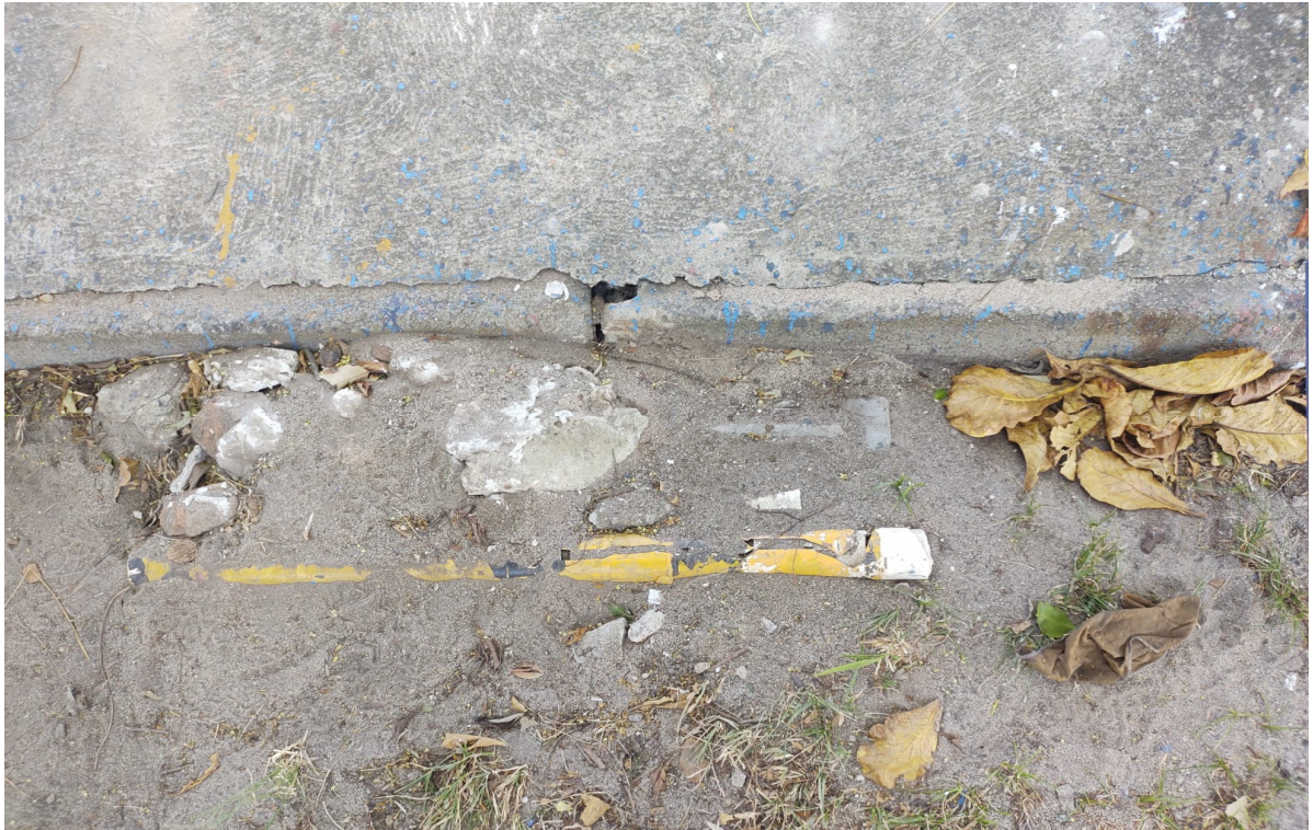
Foto 9: Piso de acesso danificado e desnivelado.
