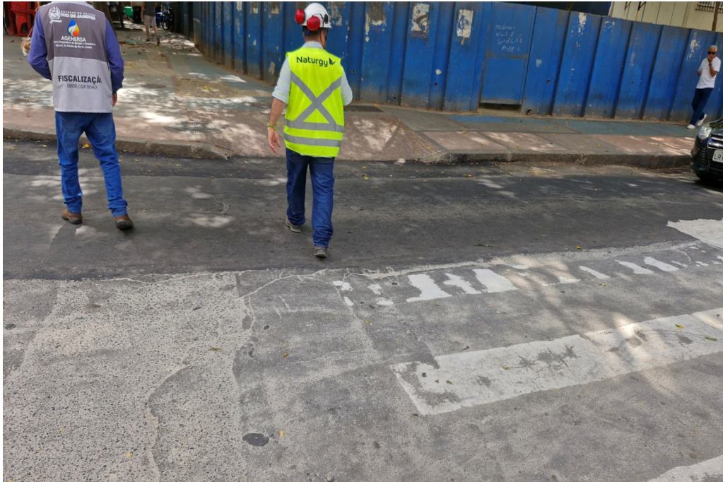
Foto 11: Trecho de recomposição faltando pintura da faixa de pedestres
