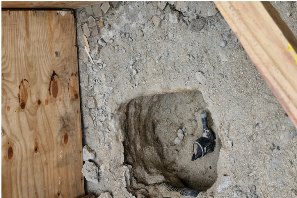
Foto 8: Ponto de purga da rede.
