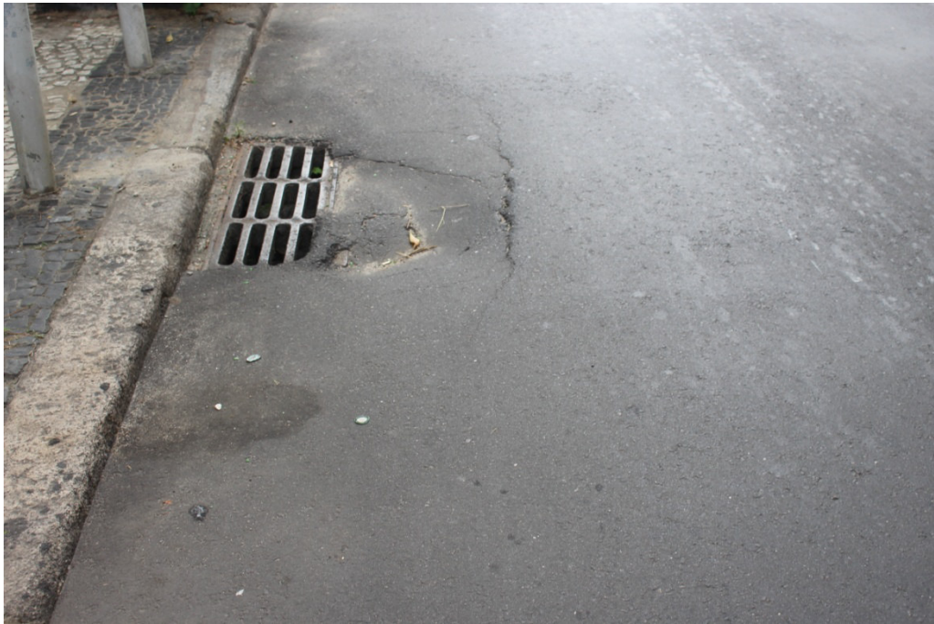
Foto 15: Afundamento do asfalto em trecho de recomposição permanente
