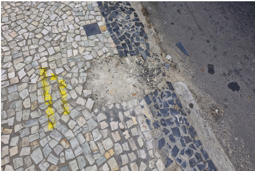
Foto 12: Trecho onde a recomposição provisória não acertou o nivelamento com a rua, gerando risco de acidentes.
