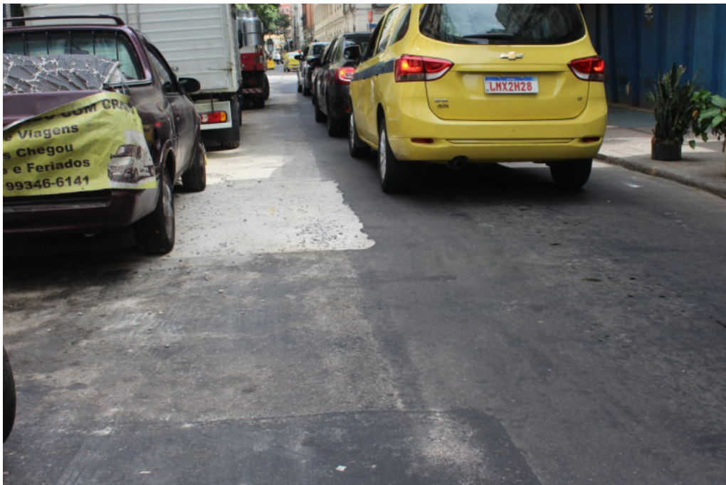
Foto 14: Trecho com recomposição provisória insuficiente
