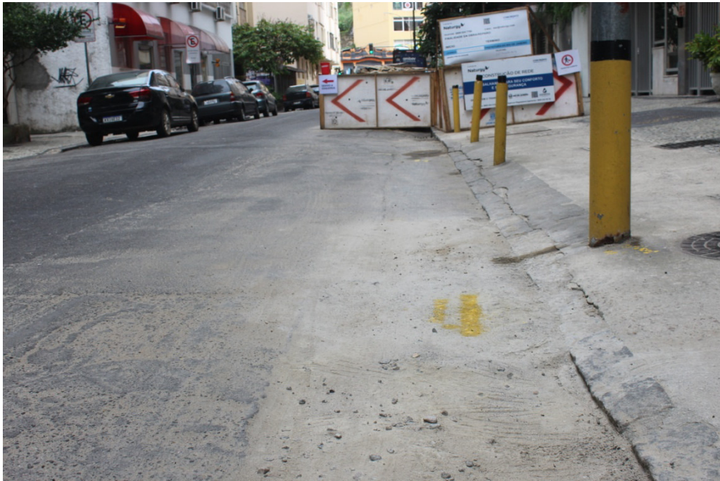
Foto 13: Trecho com recomposição provisória insuficiente.
