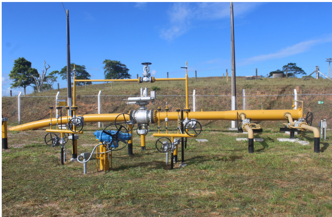
Foto 3: Lançador de pig e válvulas
