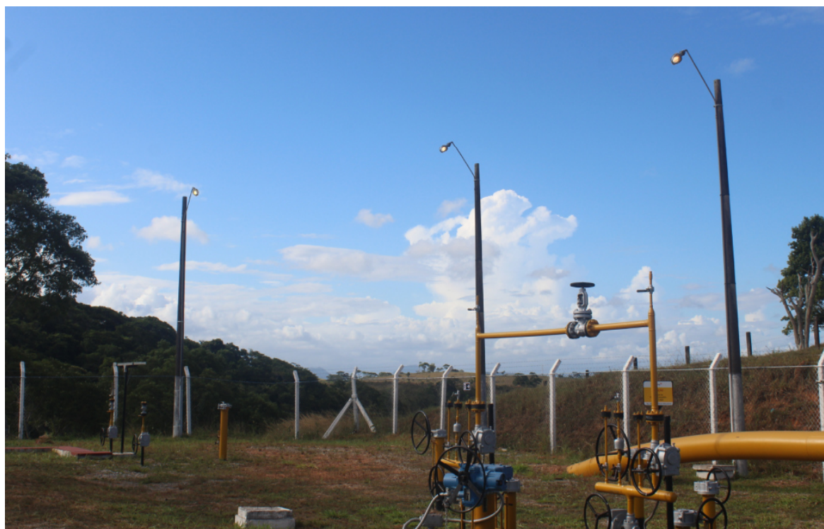
Foto 6: Iluminação geral da estação
