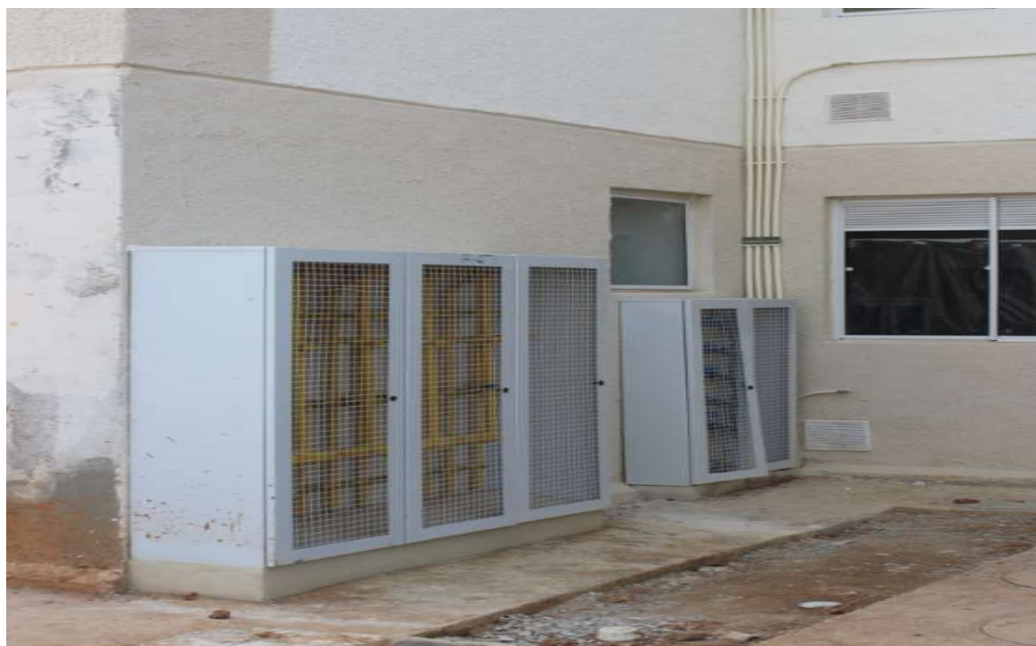
Foto 3 : instalação para regulador e medidores
