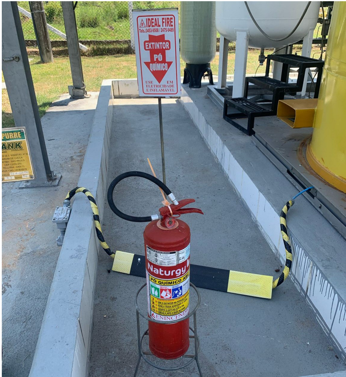
Foto 12: Extintor de Pó Químico da estação.
