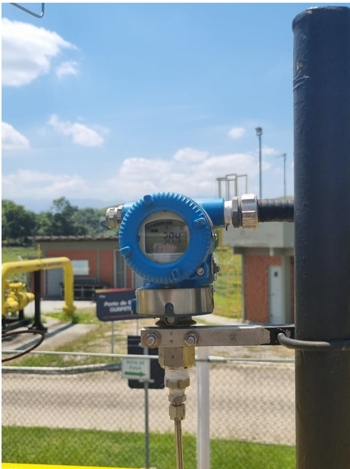
Foto 8: Medidor de Pressão da estação.
