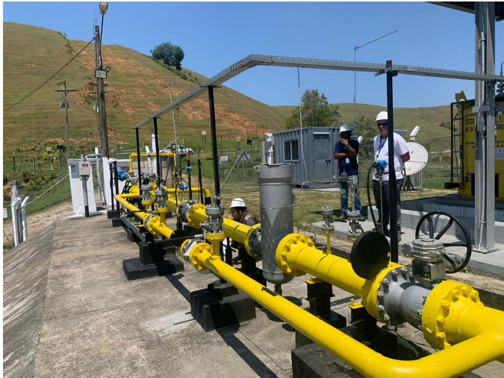
Foto 4: Estação de Medição e Odorização - Guapimirim
