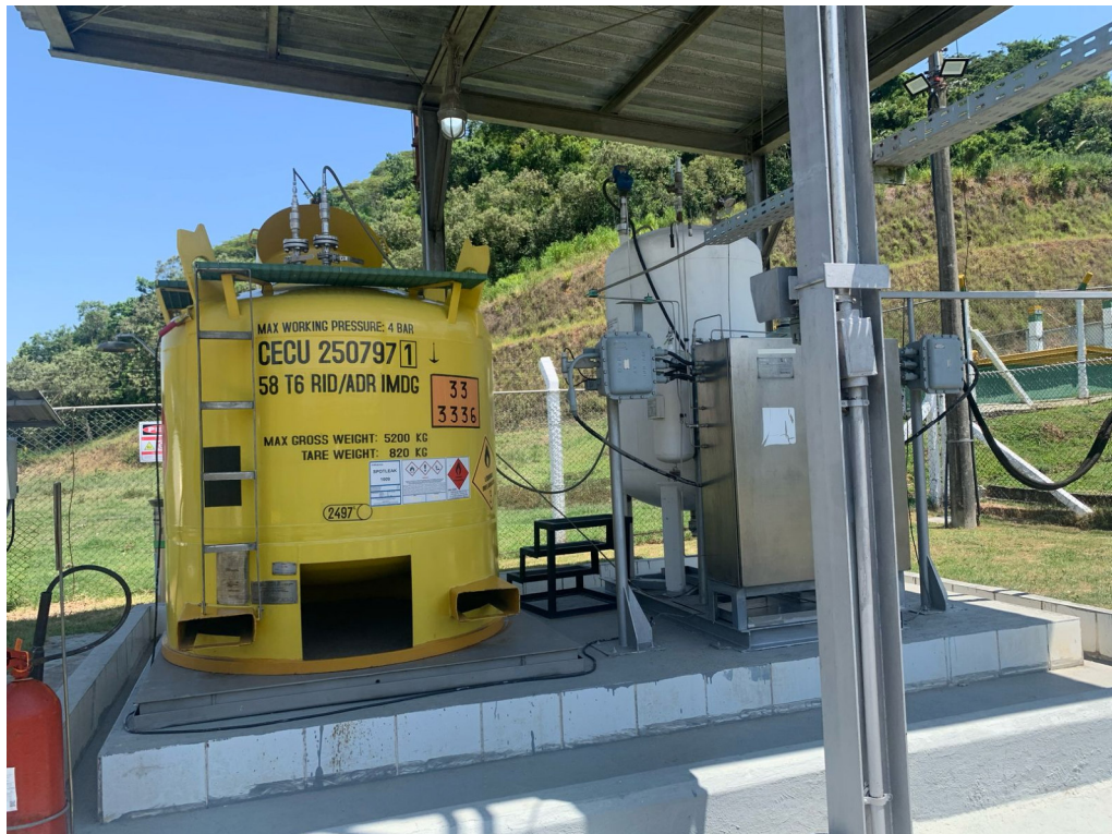
Foto 2: Sistema de Odorização da estação.
