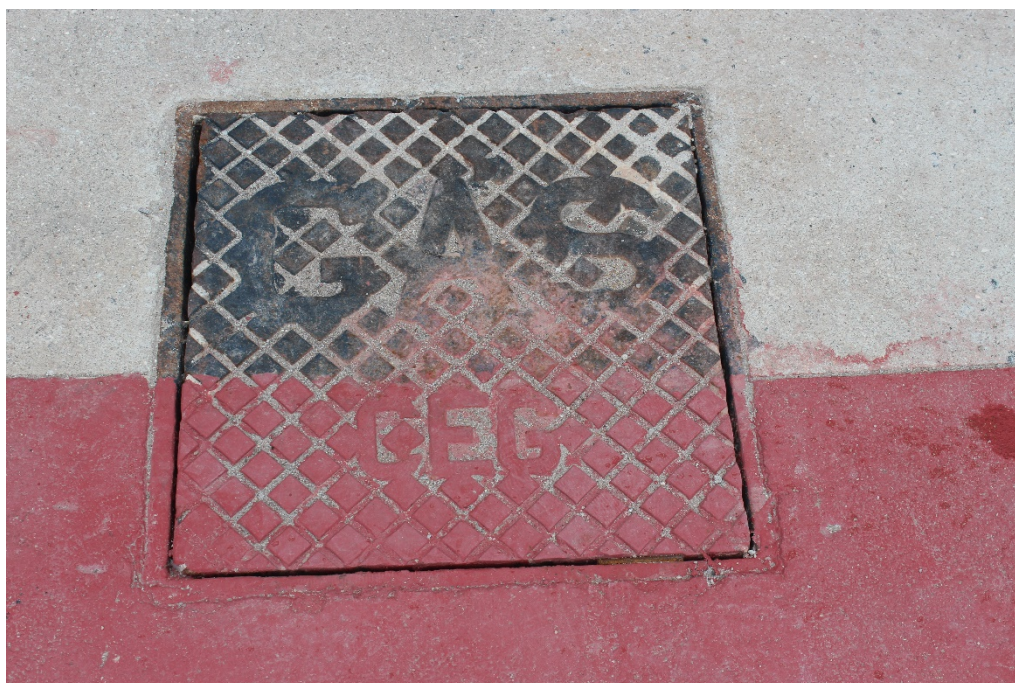
Foto 8: Caixa da válvula de ramal do cliente.
