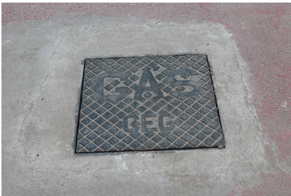
Foto 2: Caixa da válvula de rede.
