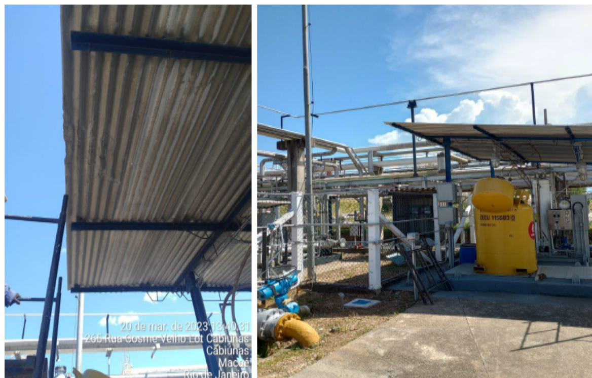
Foto 6: Telhado amassado (antes e depois)
