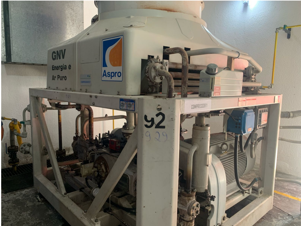
Foto 5: Compressor em funcionamento na Estação.
