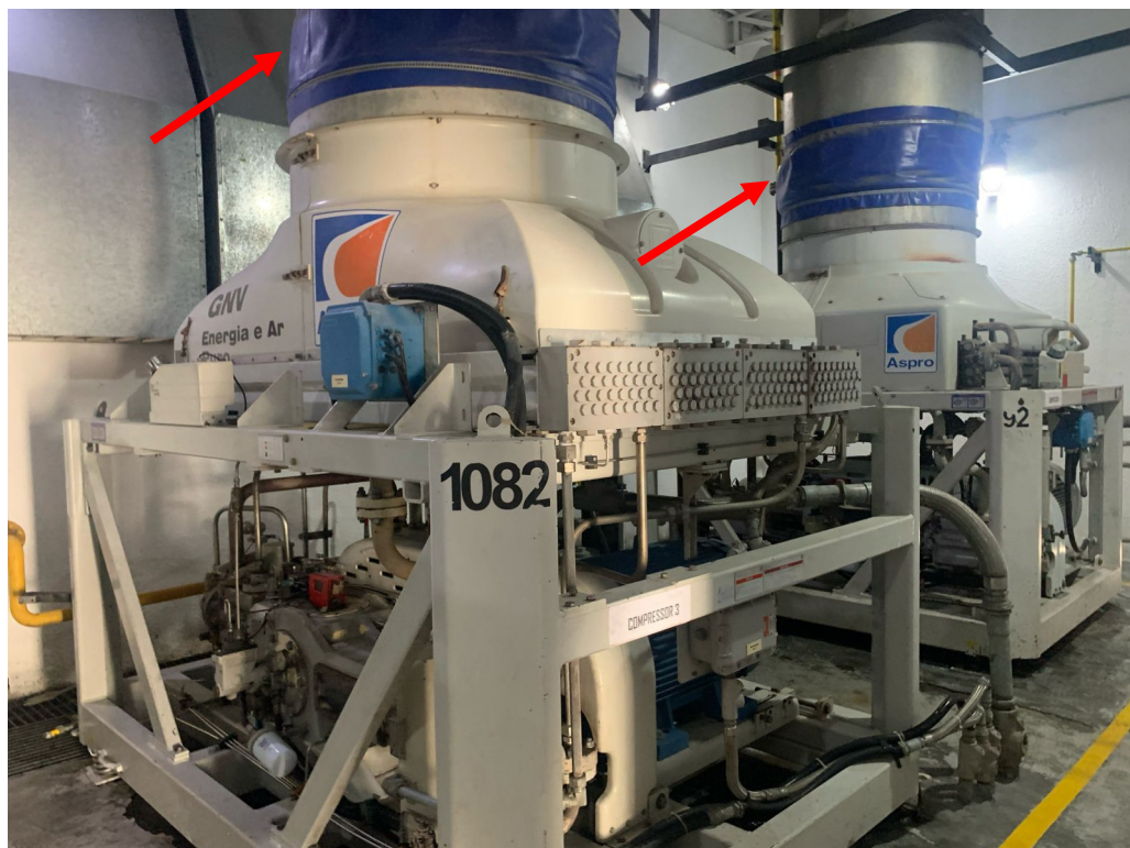
Foto 6: Compressores em funcionamento na Estação, com destaque para o sistema de proteção acústica.
