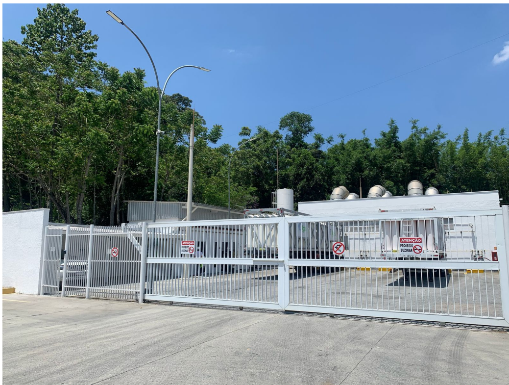
Foto 2: Entrada da Estação de Compressão de Cadete Fabres em Guapimirim/RJ.
