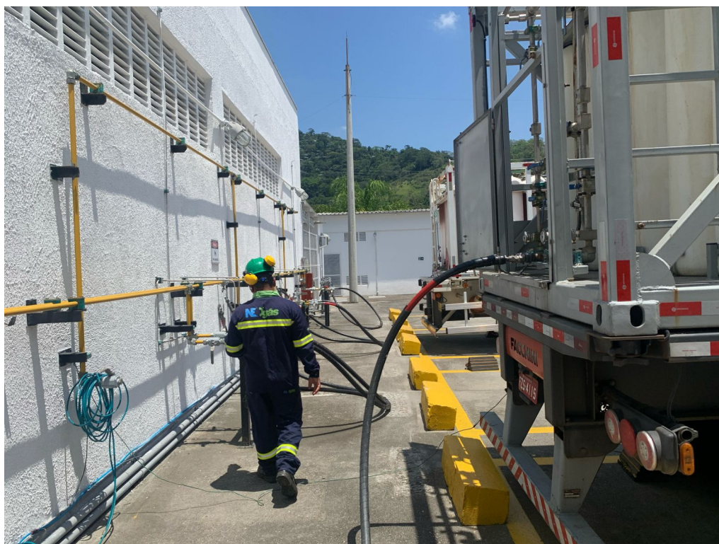
Foto 7: Sistema de abastecimento das carretas.
