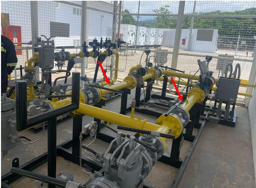
Foto 3: Sistema com duas linhas de filtragem e medição.
